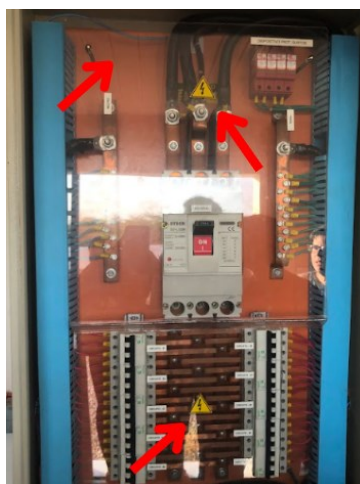
Figura 6. Barreira de acrílico que protege as partes energizadas do quadro de proteção CA. Fonte: Autoria própria (2024).
