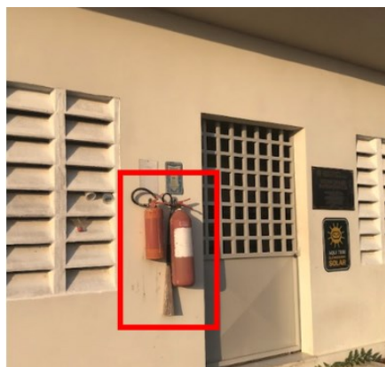
Figura 4. Extintor de incêndio exposto a condições de intempéries. Fonte: Autoria própria (2024).
