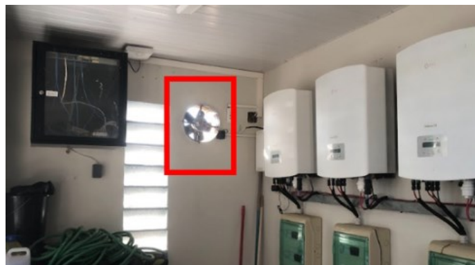
Figura 2. Sistema auxiliar de ventilação forçada na casa dos inversores. Fonte: Autoria própria (2024).
