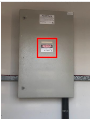
Figura 5. Sinalização de advertência sobre o risco de choque elétrico do quadro de proteção CA. Fonte: Autoria própria (2024).
