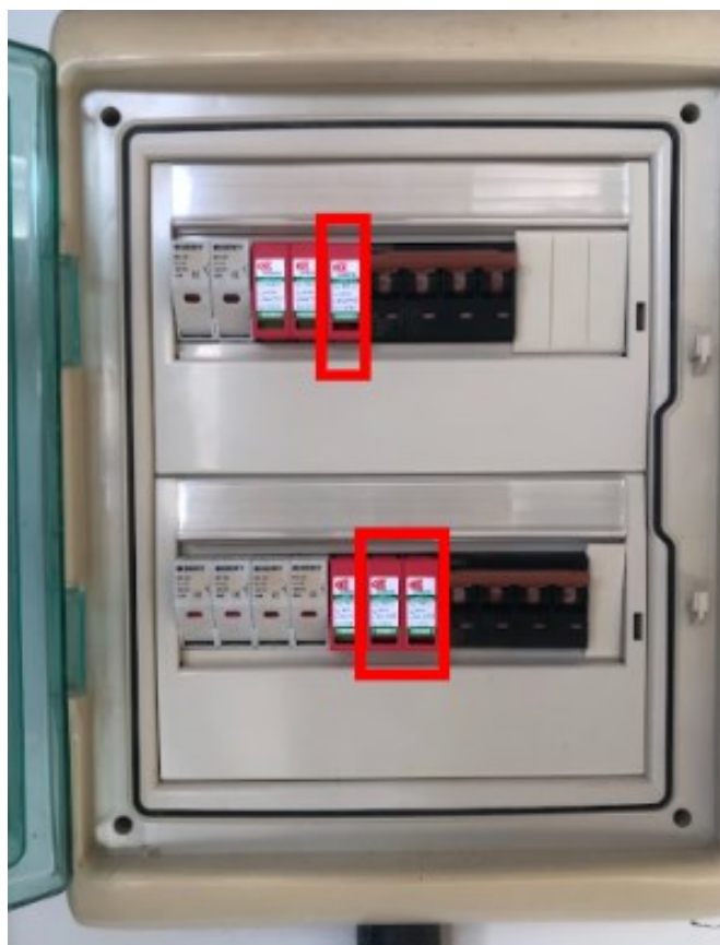
Figura 3. Quadro de proteção CC do inversor 06 com os DPS atuados. Fonte: Autoria própria (2024).
