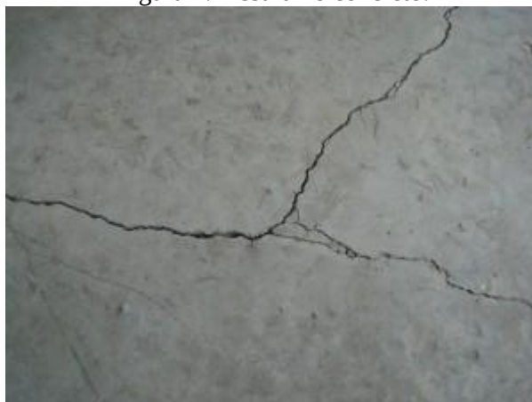
Figura 4: Fissura no concreto.
