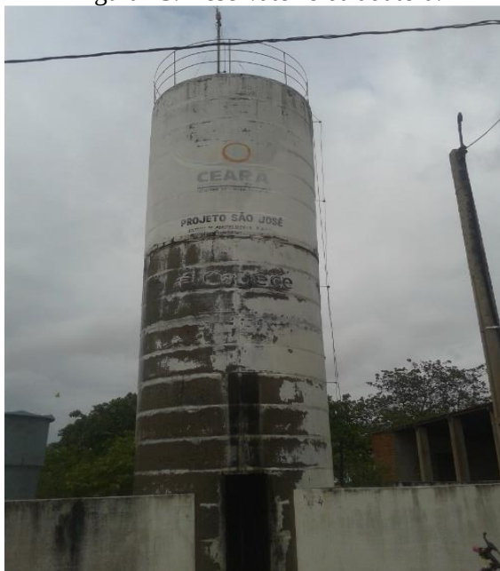
Figura 13: Reservatório da adutora.
