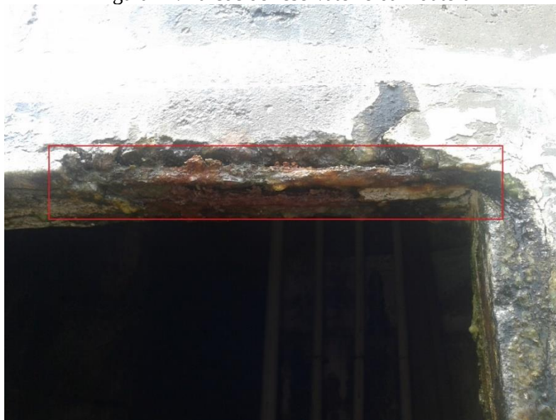
Figura 22: Parede do reservatório da Adutora
