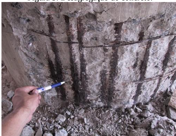
Figura 3: Desagregação do concreto.
