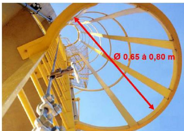
Figura 12: Gaiola de proteção
