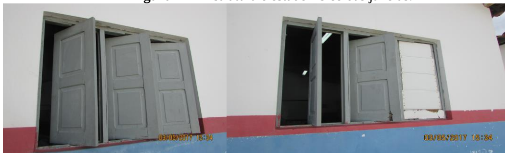
Figura 21 – Estrutura e estado físico das janelas.
