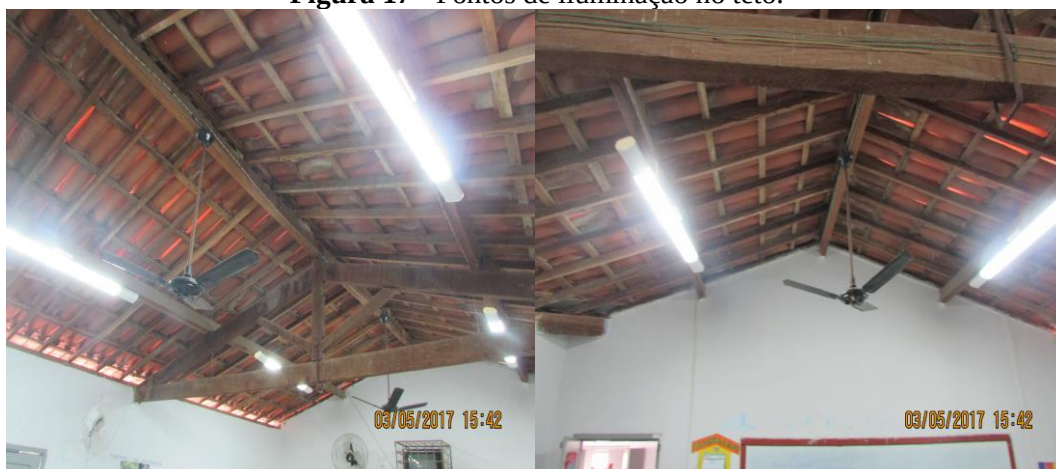
Figura 17 - Pontos de iluminação no teto.
