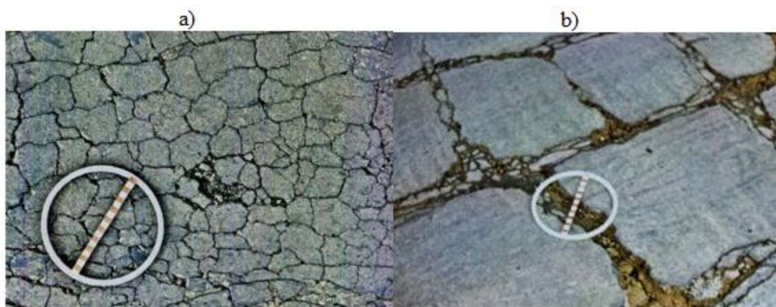
Figura 08 – Trincas interligadas: a) tipo jacaré; b) tipo bloco
