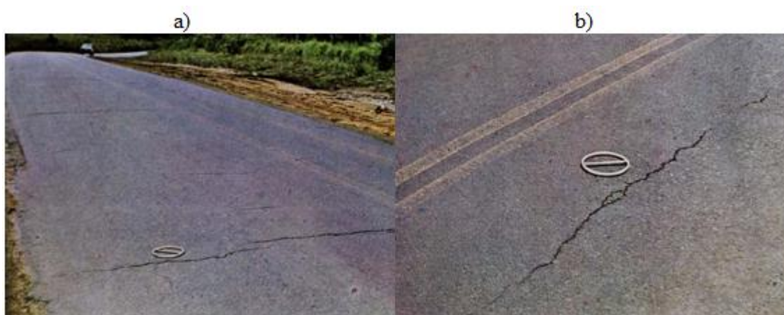
Figura 07 – Trincas isoladas: a) transversal; b) longitudinal
