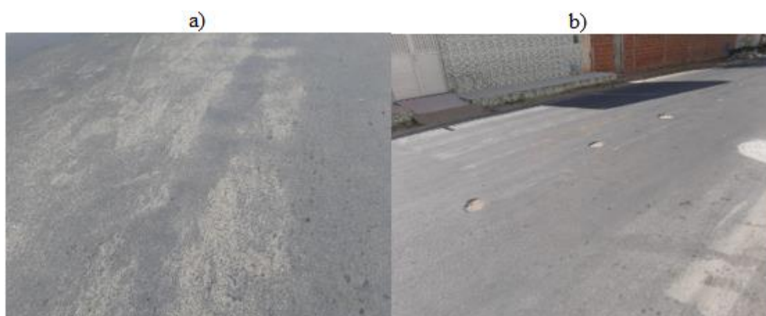
Figura 23 – Defeitos de superfície: a) desgaste; b) buracos
