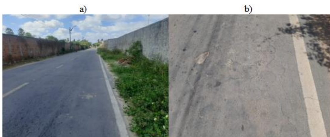
Figura 24 – Defeitos de superfície: a) ondulação; b) trincas interligadas
