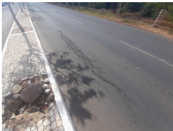
Figura 34 – Defeitos de superfície: trincas interligadas
