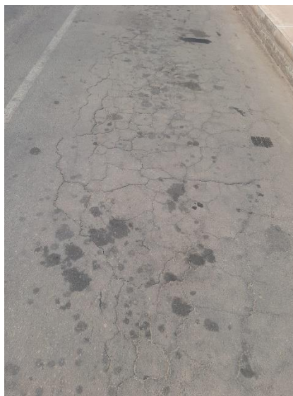
Figura 30 – Defeitos de superfície: trincas interligadas
