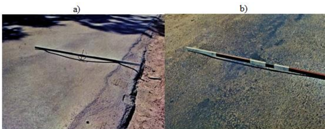
Figura 09 – Afundamento: a) trilha de roda; b) local
