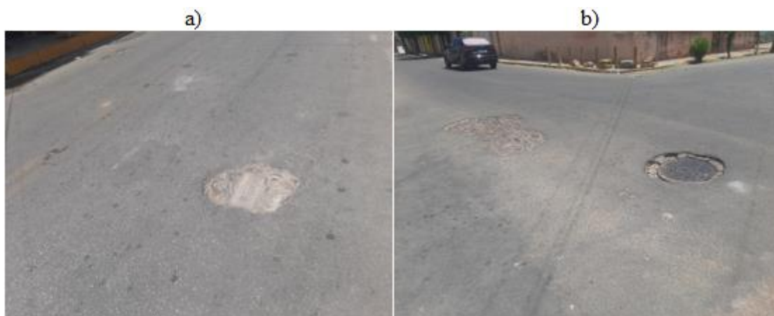
Figura 27 – Defeitos de superfície: a) buraco; b) elemento do SES
