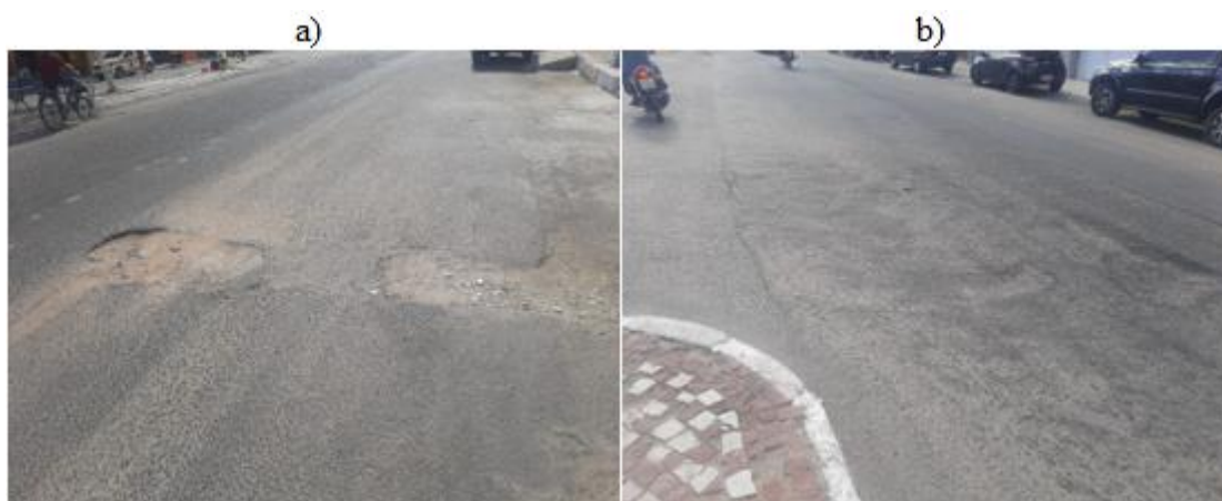
Figura 32 – Defeitos de superfície: a) buracos; b) Afundamento com desgaste
