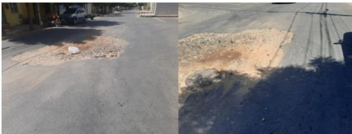
Figura 25 – Defeito de superfície: buraco no meio da via com trincas nas bordas
