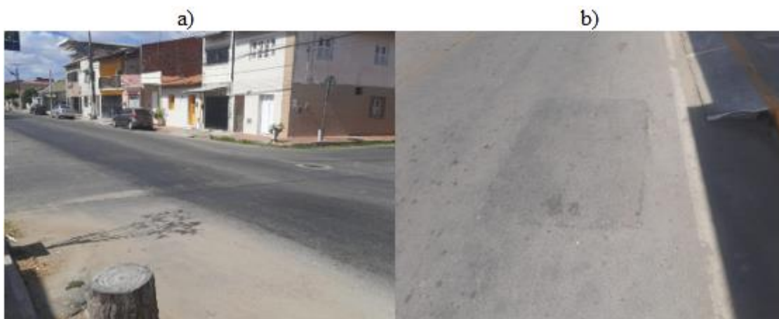
Figura 29 – Defeitos de superfície: a) ondulação; b) remendo
