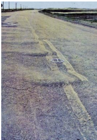
Figura 10 – Ondulação ou corrugação
