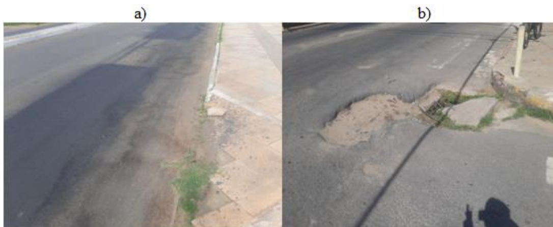
Figura 36 – Defeitos de superfície: a) remendos; b) buraco
