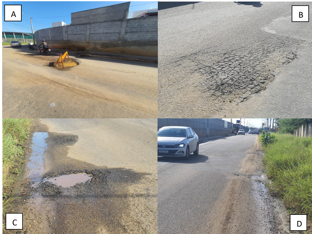
Figura 31: A) Panela; B) Trinca couro de jacaré; C) Panela + couro de jacaré; D) Remendo
