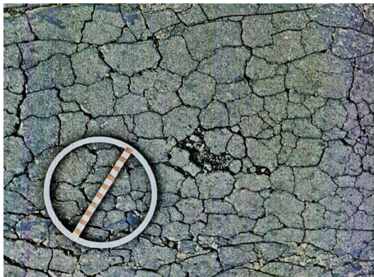
Figura 9: Trinca interligada - "Couro de jacaré"
