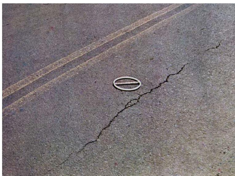
Figura 7: Trinca isolada - Longitudinal
