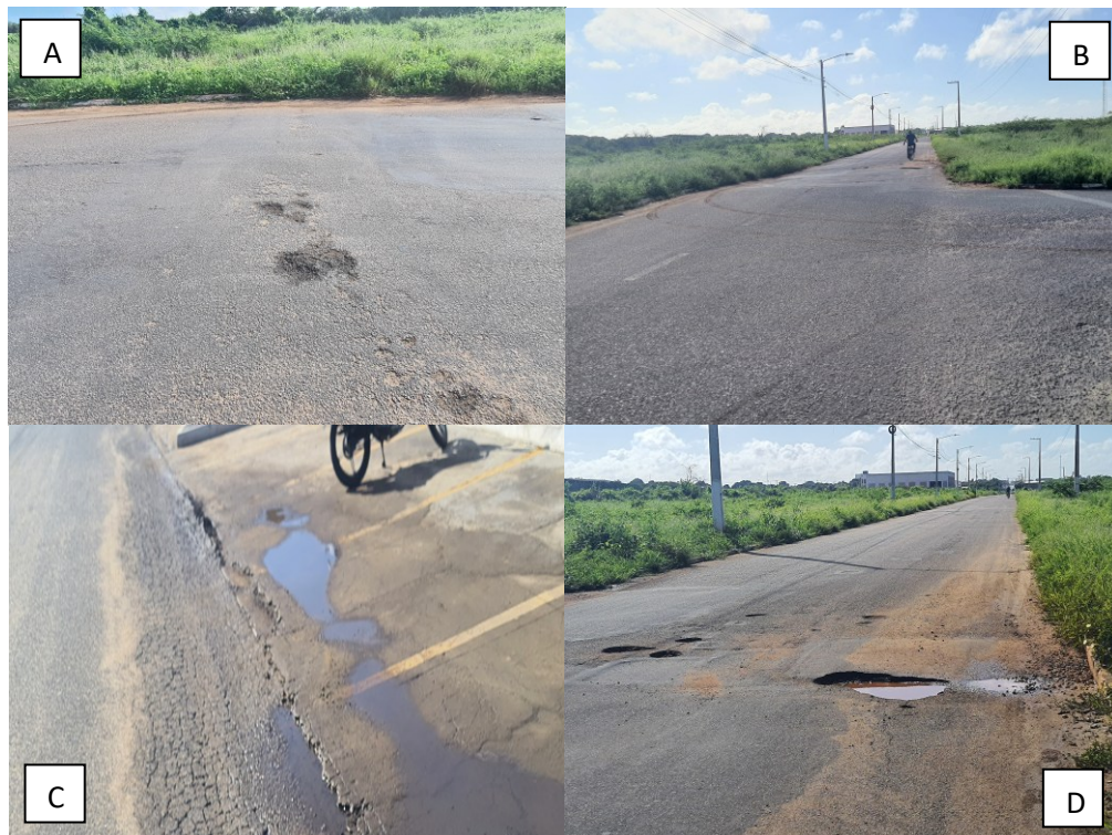
Figura 35: A) Desgaste + remendo; B) Desgaste; C) Trinca couro de jacaré; D) Painéis + remendos
