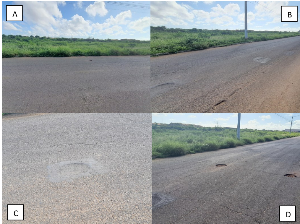
Figura 36: A) Trinca do tipo bloco; B) e C) Remendo com afundamento; D) Painelas + trincas de bloco
