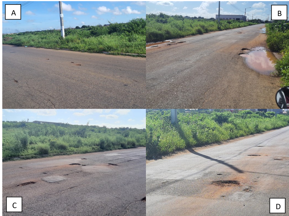
Figura 38: A) Desgaste + trincas do tipo bloco; B), C) e D) Aglomerado de remendos + painelas
