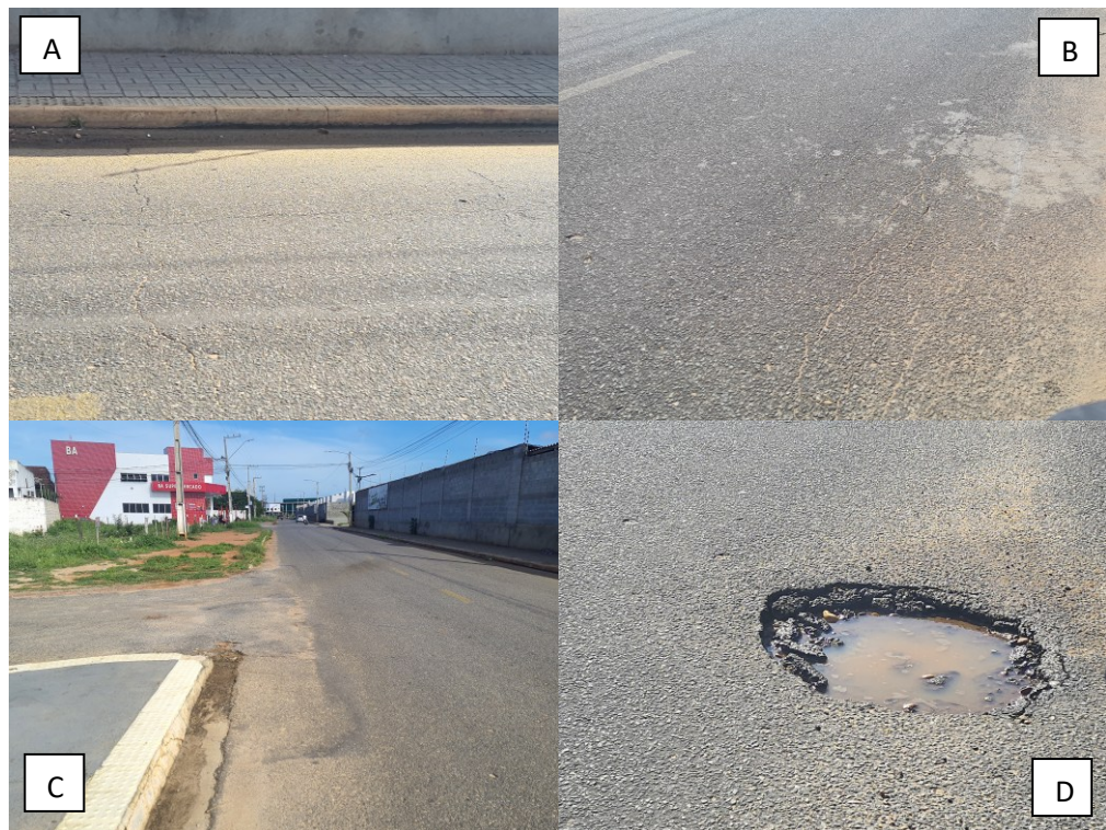
Figura 33: A) Trincas isoladas; Trincas isoladas + desgaste; C) Escorregamento; D) Panela
