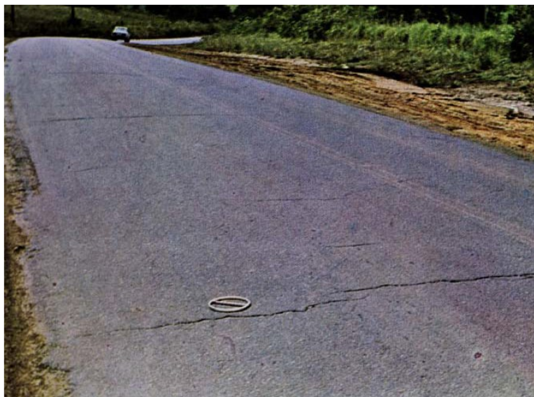
Figura 6: Trinca isolada - Transversal
