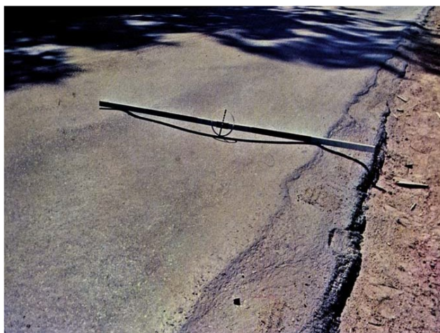
Figura 12: Afundamento de consolidação
