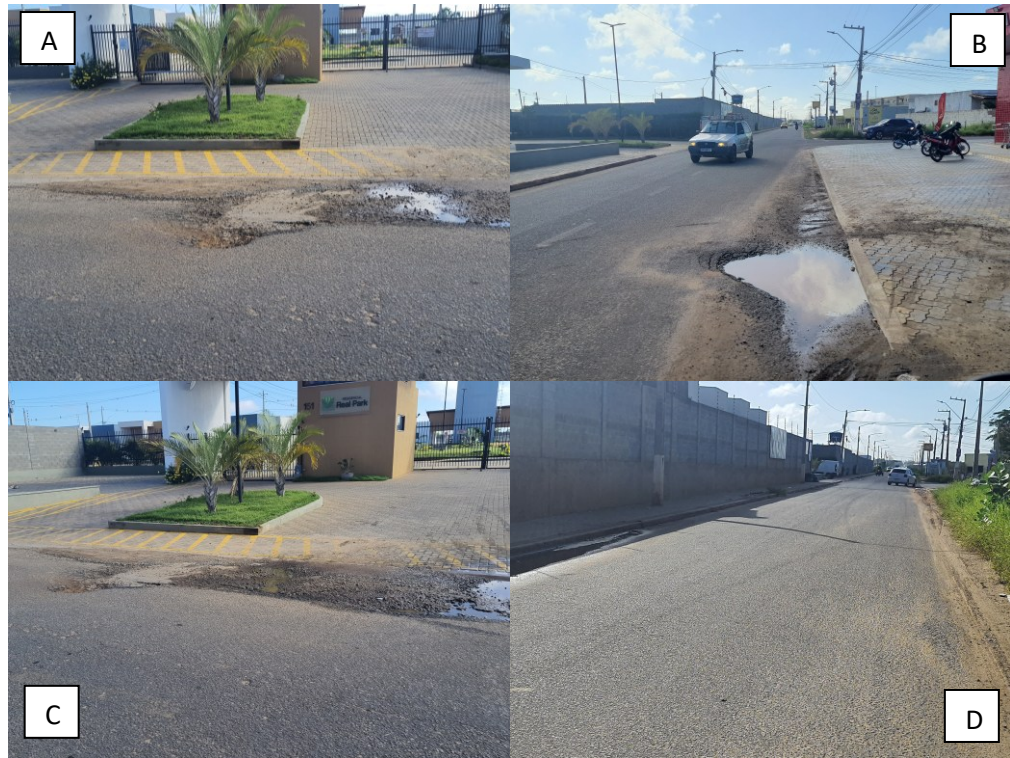
Figura 32: A) Afundamento; B) Panela; C) Desgaste; D) Desgaste
