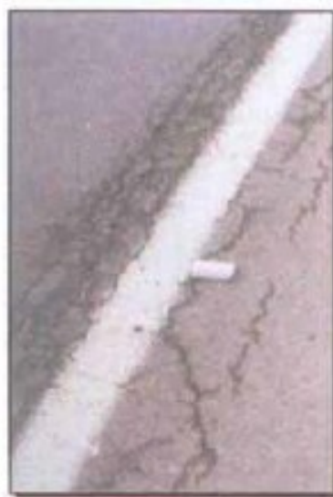
Figura 8: Trinca isolada - Retração
