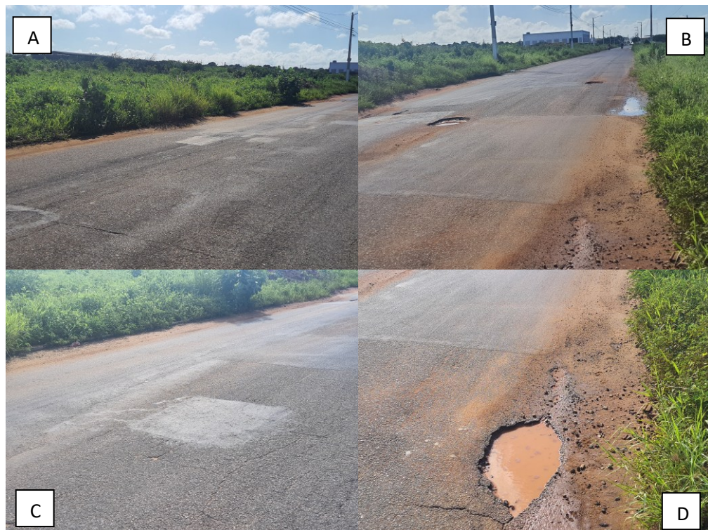
Figura 37: A), B) e C): Aglomerado de remendos com ondulação; D) Painela
