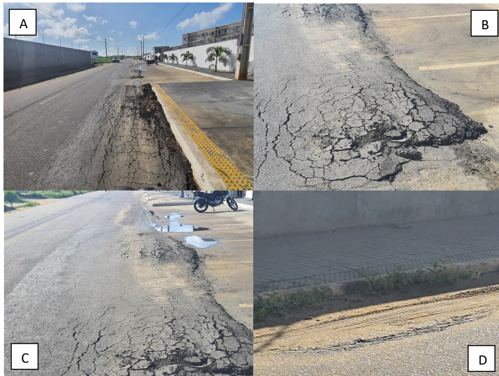
Figura 34: A) afundamento de trilha de roda com trincamento e desagregação lateral; B) Trinca couro de jacaré com desagregação avançada; C) Afundamento + defeito da foto B; D) Afundamento de trilha de roda
