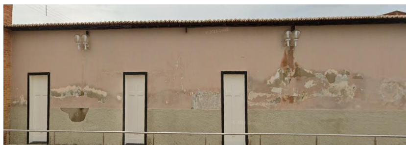
Figura 33 - Substrato com mancha de umidade, salitre, fungo e bolor na igreja.
