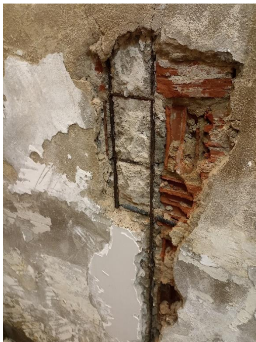
Figura 32 - Substrato com presença de salitre, manchas de umidade e corrosão de armadura na residência unifamiliar.
