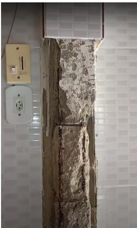
Figura 40 - Pilar com alto nível de degradação e sem estribos.
