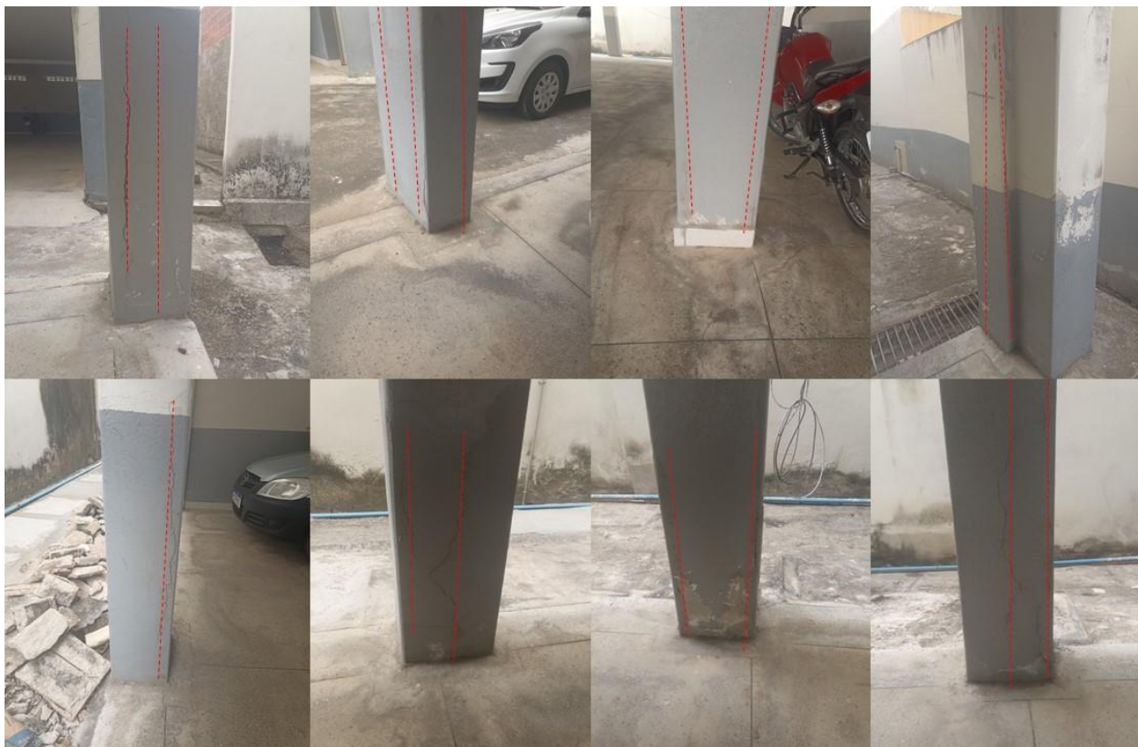
Figura 35 - Fissuras de corrosão nas armaduras longitudinais dos pilares do prédio.
