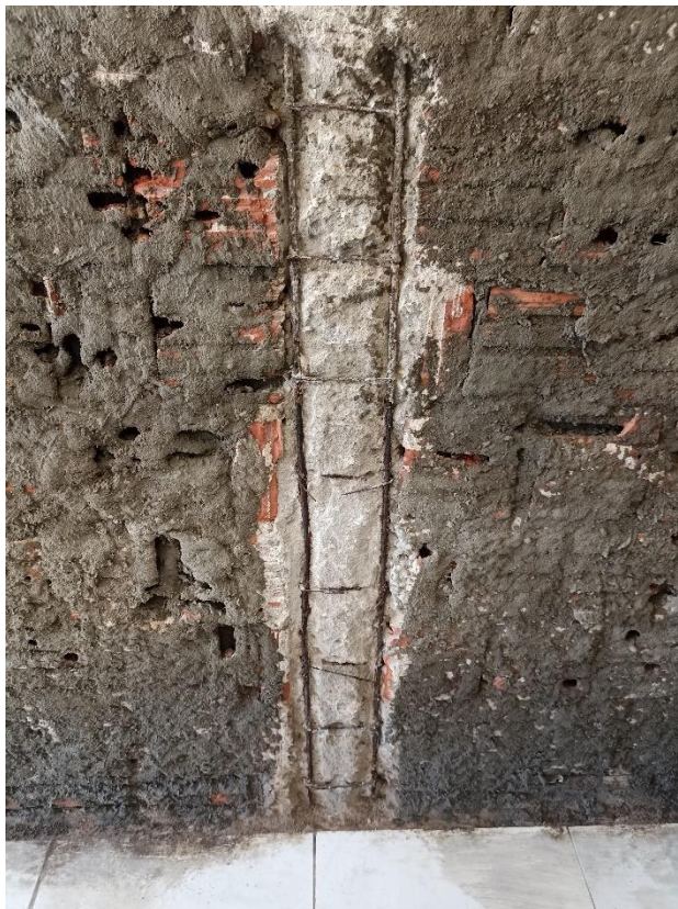
Figura 38 - Pilar em processo corrosivo bastante agressivo.
