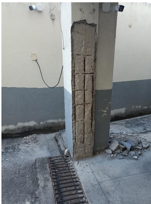
Figura 31 - Pilar em estágio avançado de deterioração.
