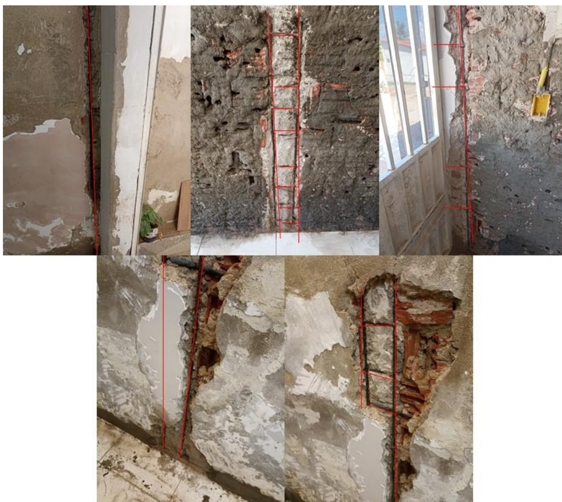
Figura 37 - Pilares com alto nível de degradação devido a corrosão de armaduras.
