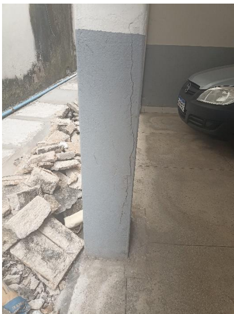
Figura 30 – Outro Pilar de “canto” com fissuras verticais alinhadas com as barras longitudinais.
