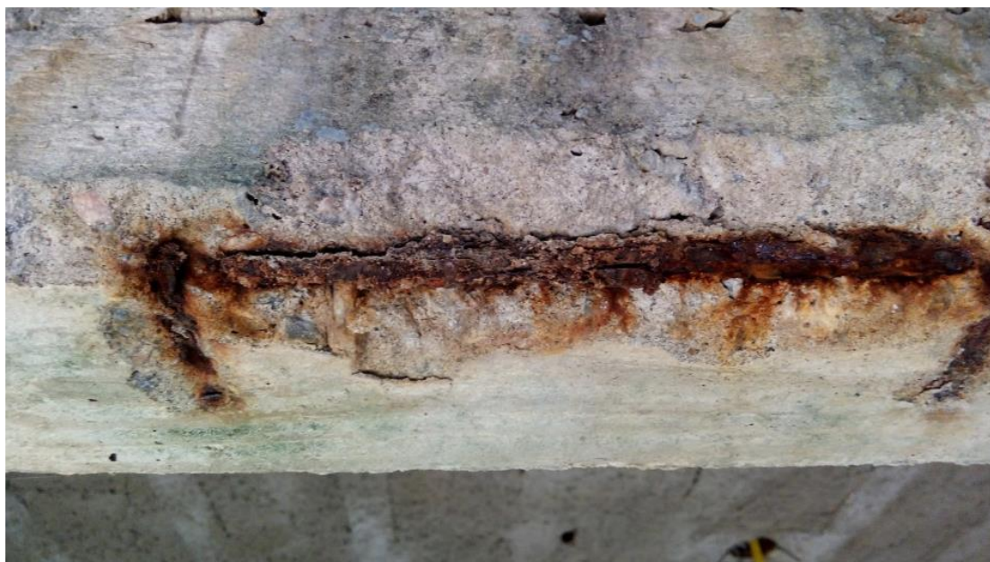
Figura 11 – Corrosão de armadura em viga de concreto, sofrendo ataque de cloretos e carbonatação.
