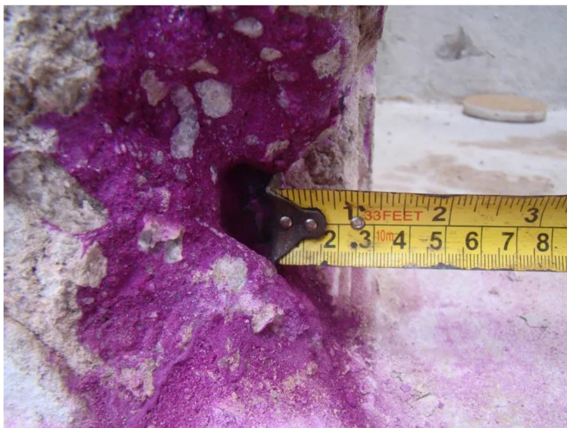
Figura 10 – Teste de carbonatação do concreto com solução de fenolftaléina, pH acima de 9, sem carbonatação.
