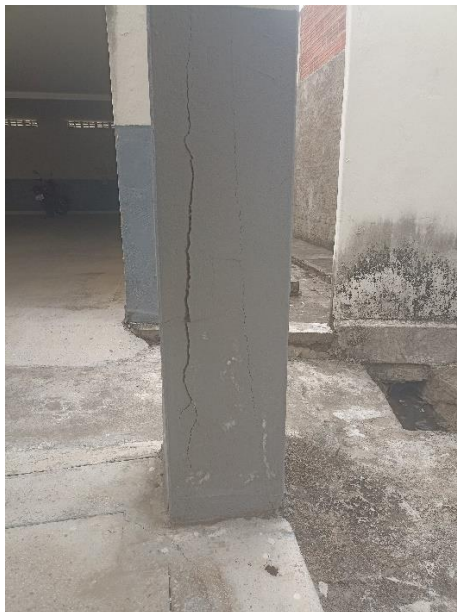
Figura 29 - Pilar de “canto”, do prédio com fissuras verticais alinhadas com as barras longitudinais.
