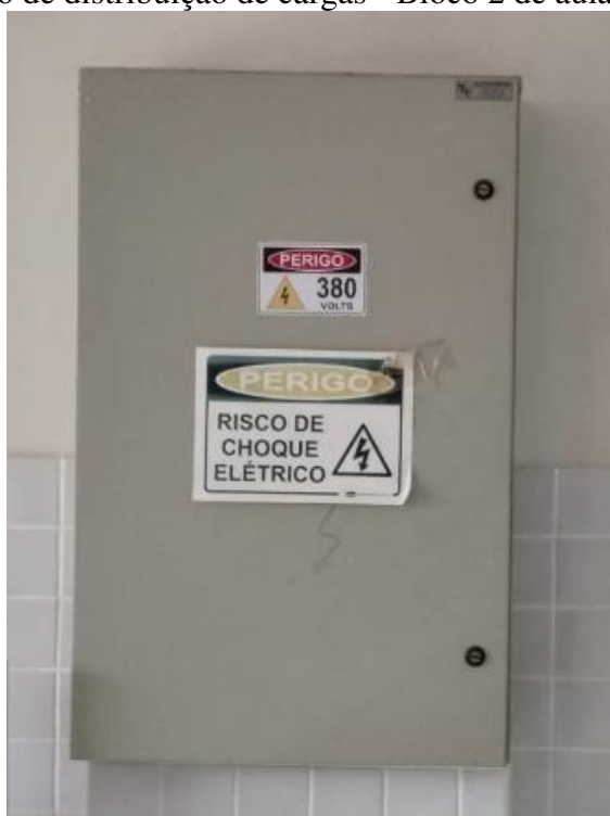
Figura 18: Quadro de distribuição de cargas - Bloco 2 de aulas (Interno).
