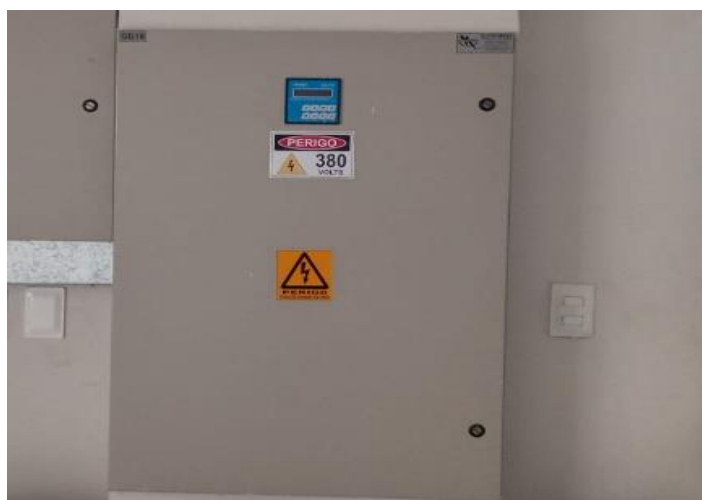
Figura 22: Quadro de distribuição- Bloco dos professores 2(interno)
