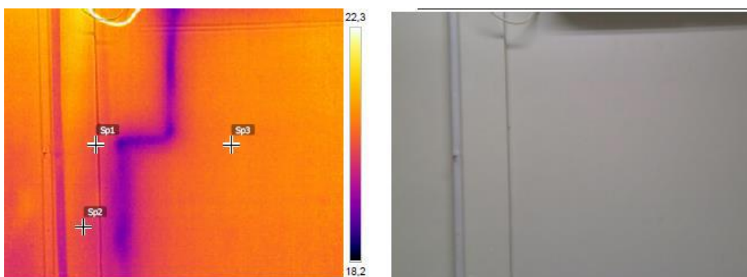
Figura 8: Localização da tubulação do dreno de ar condicionado - Verificação de vazamento.
