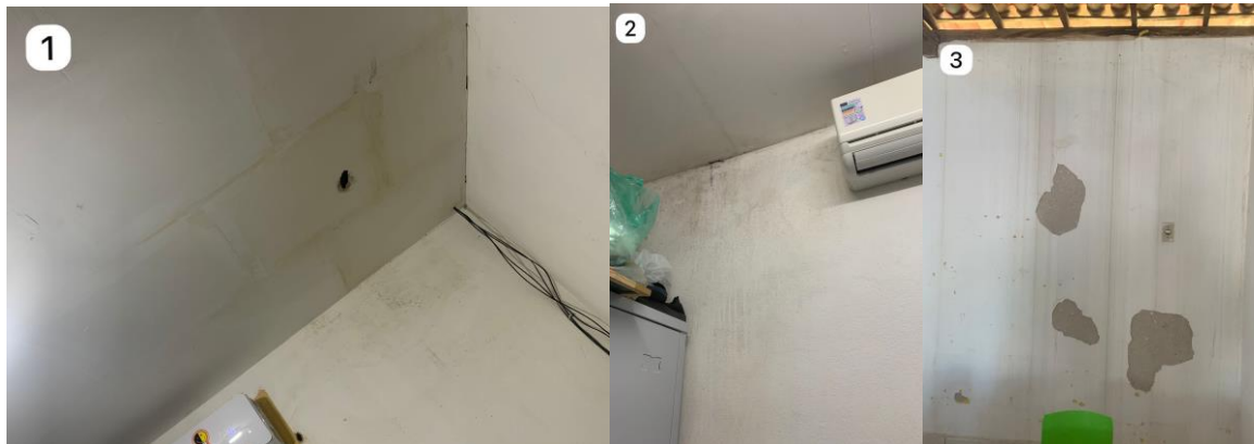
Figura 13- (1) Imagem de umidade na direção. (2) Imagem na secretaria. (3) Sala de aula.
