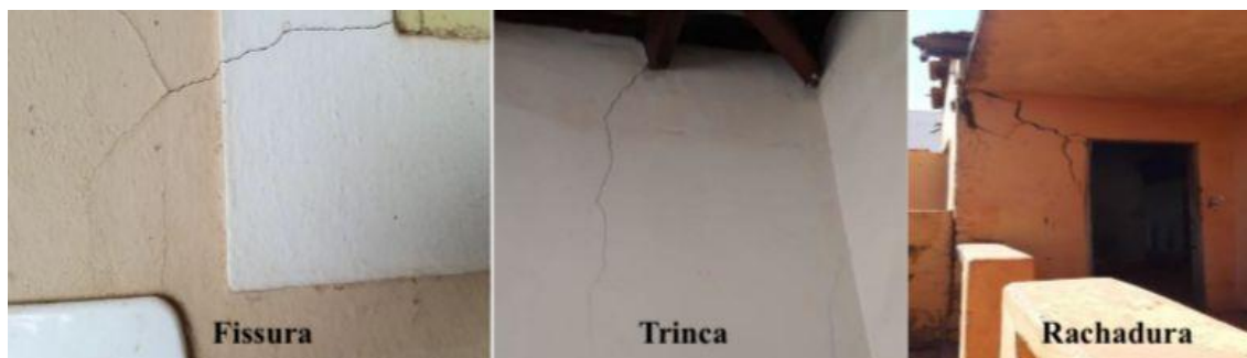
Figura 3- Fissuras, trincas e rachaduras
