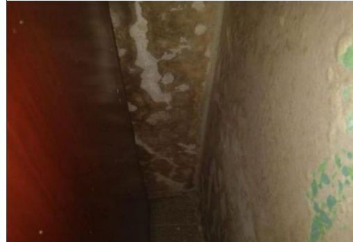
Figura 5- Bolor e Eflorescência no interior da casa
