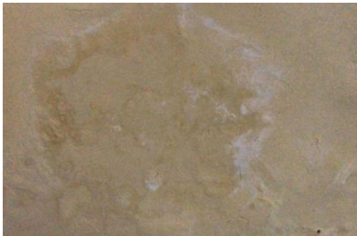
Figura 4- Eflorescência na parede
