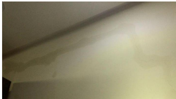
Figura 2- Danos por umidade e infiltração
