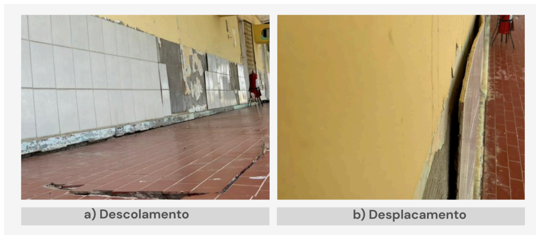
Figura 4 - Manifestação patológica por deslocamento e deslocamento
