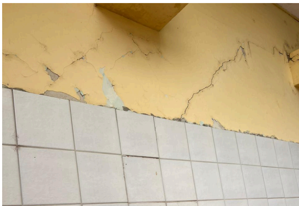
Figura 3 - Manifestação patológica por Fissuras em alvenaria
