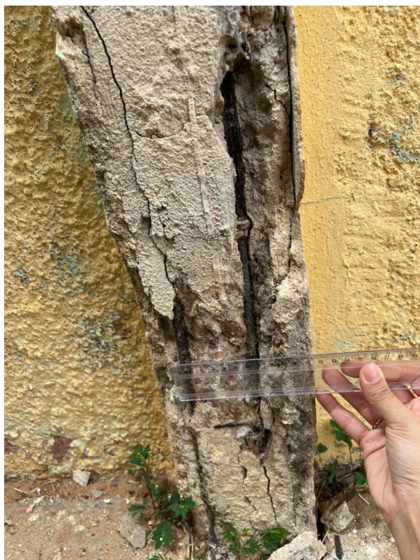
Figura 25 - Pilar com armadura exposta
