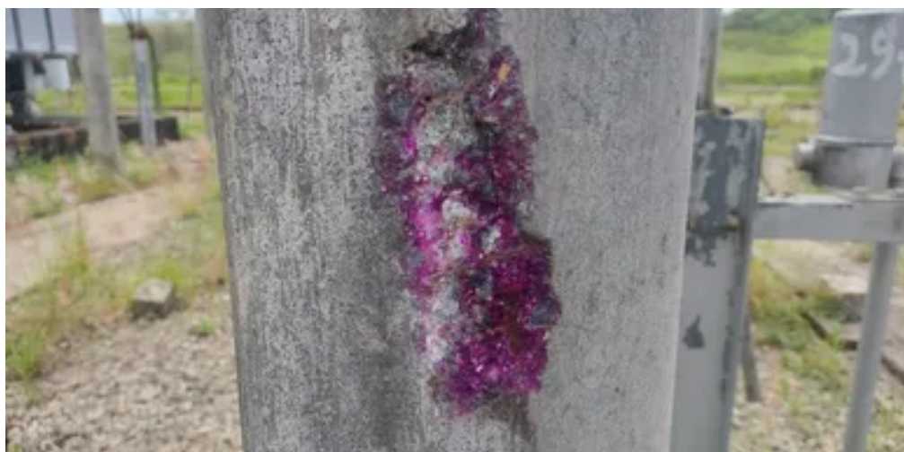
Figura 7 - Pilar não carbonatado
