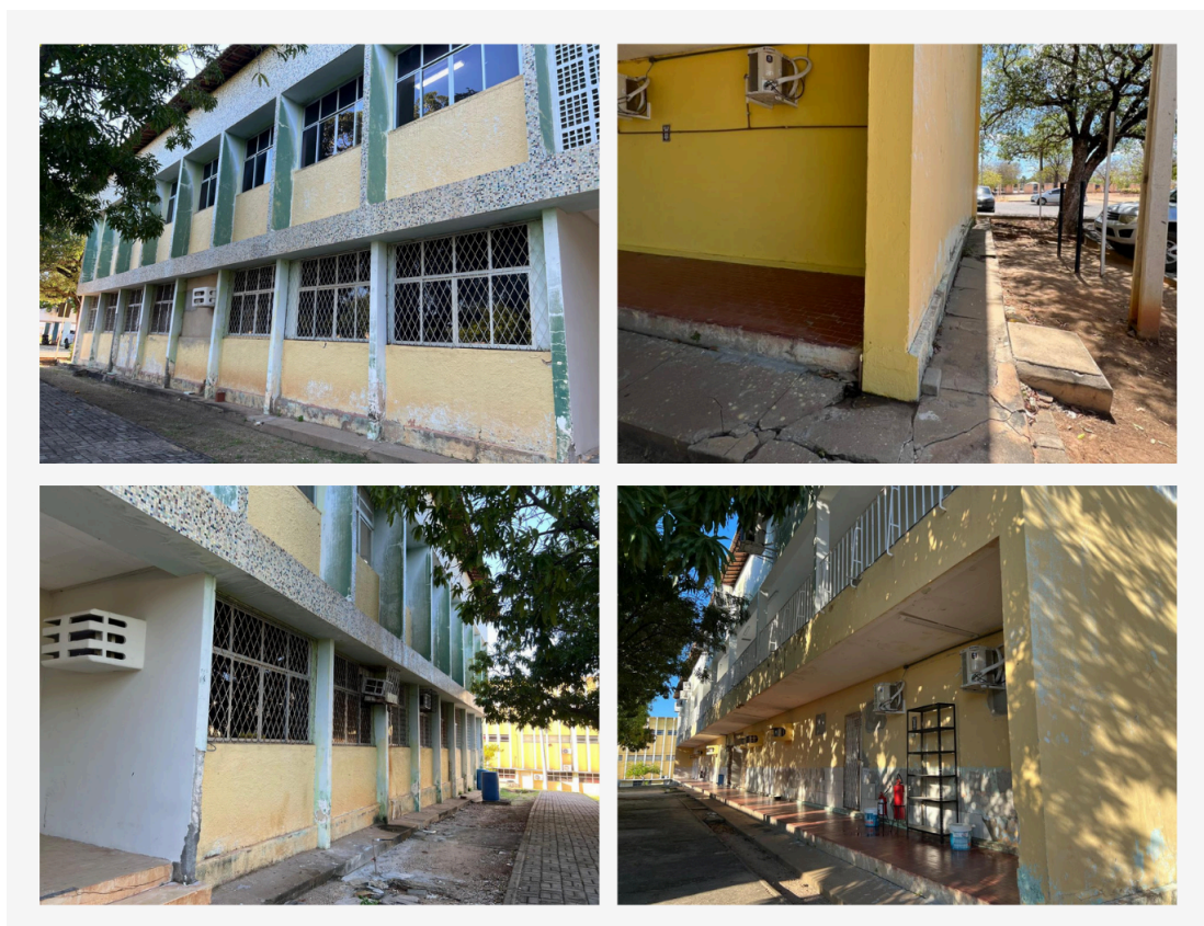
Figura 15 - Mapeamento das manifestações patológicas do bloco engenharias
