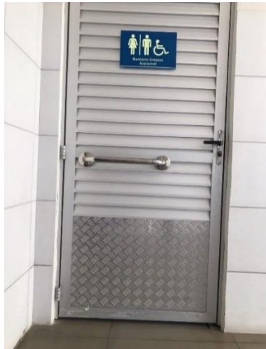
Figura 11: Porta unissex do banheiro adaptado para cadeirantes.
