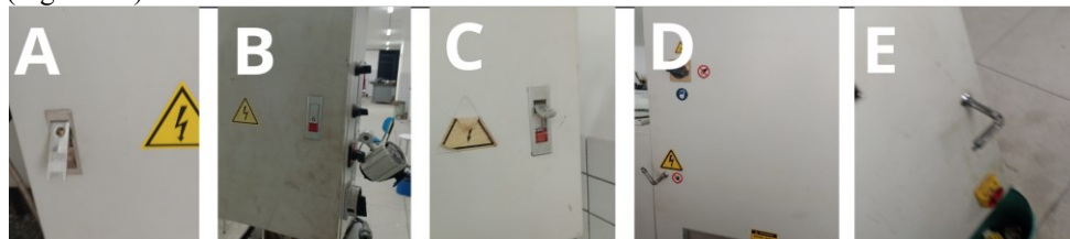
FIGURA 5. Instalações e dispositivos elétricos do laboratório de usinagem da Ufersa: (A) Botão de acesso do painel elétrico da fresadora; (B) Botão de acesso do painel elétrico da furadeira de coluna; (C) Botão de acesso danificado do painel elétrico da furadeira de bancada; (D) Painel elétrico do torno mecânico com sua chave de acesso; (E) Painel elétrico do torno CNC com sua chave de acesso. Fonte: Dados da pesquisa (2024).
