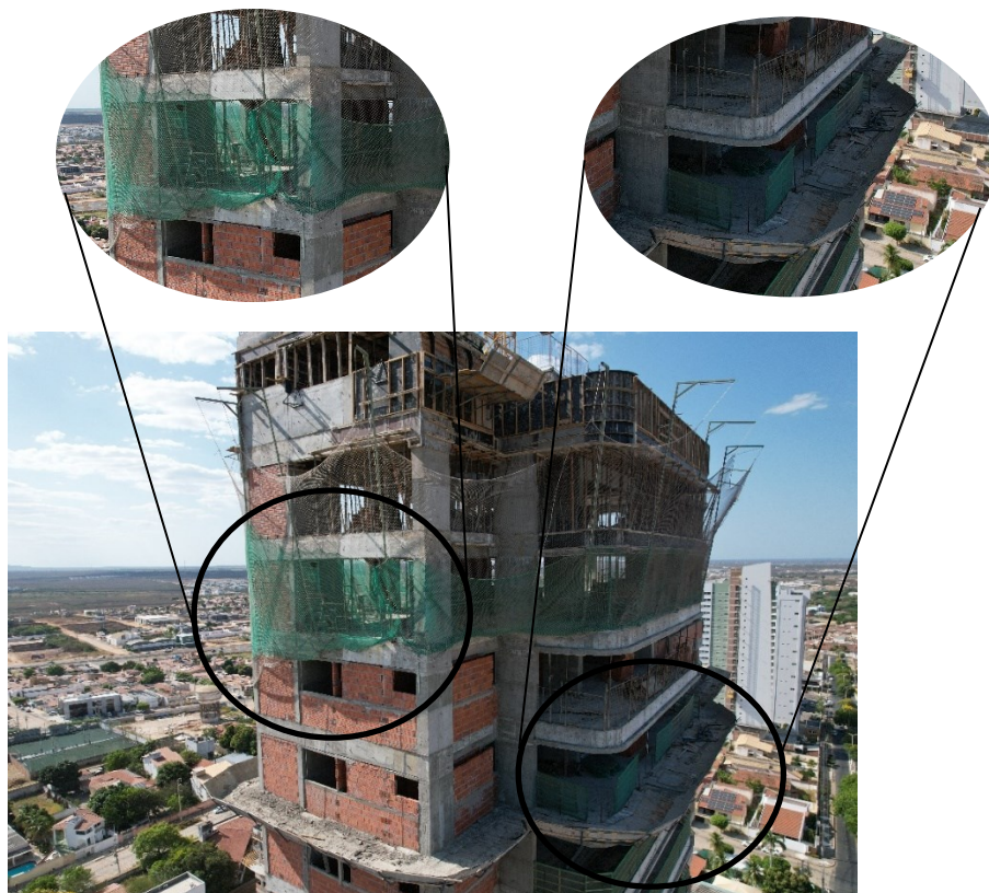
Figura 5. Tela de proteção e plataformas de proteção. Fonte: Aatoria própria (2024).
