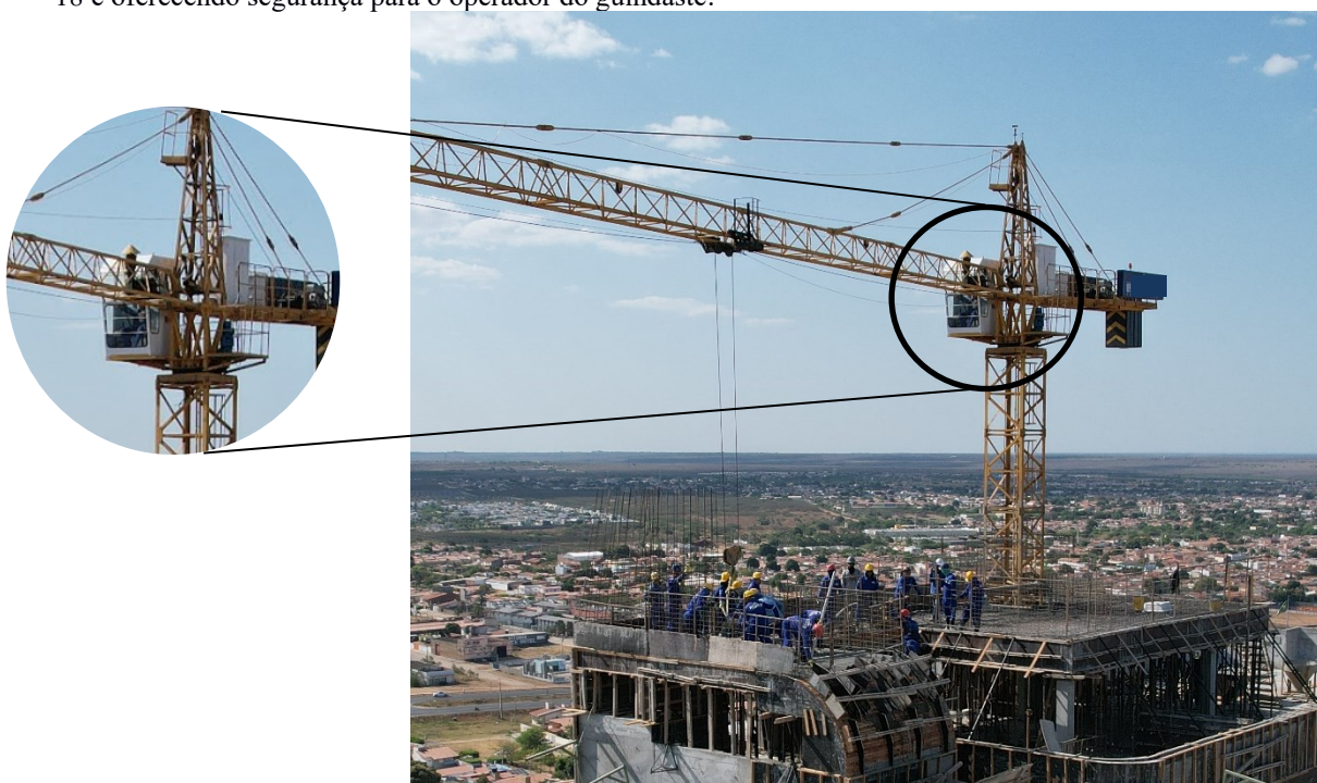
Figura 10. Cabine de controle e operação. Fonte: Autoria própria (2024).
