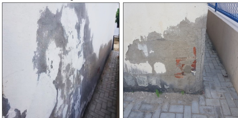
Figura 25 – Descolamento na fachada
