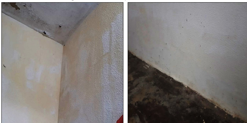
Figura 19 – Presença de eflorescências
