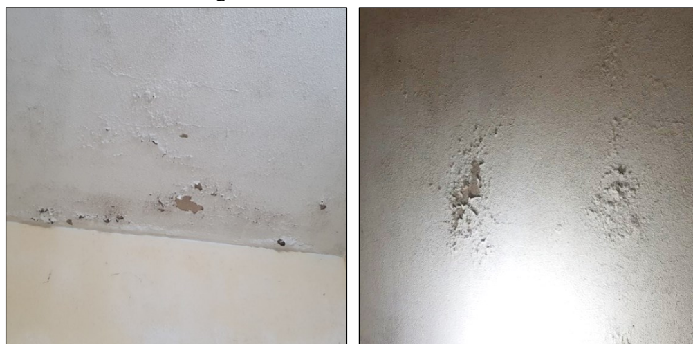
Figura 24 – Descolamento no forro
