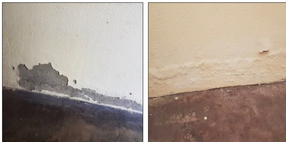
Figura 23 – Descolamento nas paredes internas (conclusão)
