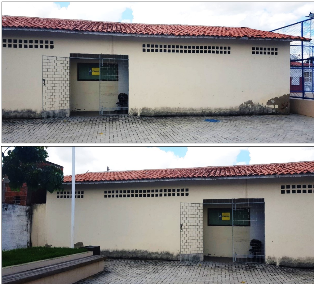
Figura 21 – Mancha por umidade na fachada
