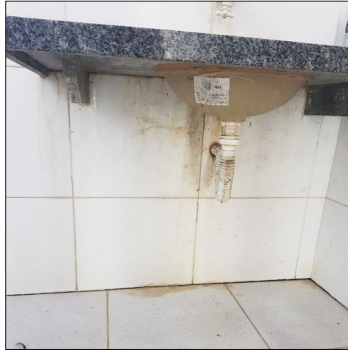
Figura 20 – Manchas por umidade no banheiro
