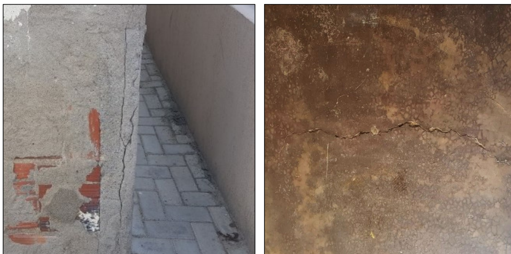
Figura 22 – Trincas e fissuras em fachada e piso
