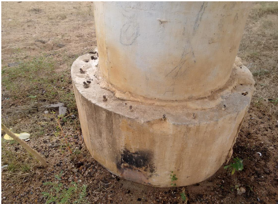
Figura 4 – Armaduras da fundação exposta.
