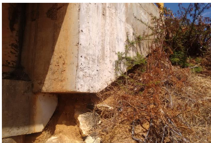
Figura 9 – Estrutura suspensa devido a erosão.
