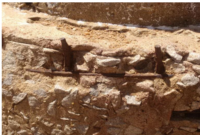
Figura 10 – Pilar com a armadura da fundação exposta.
