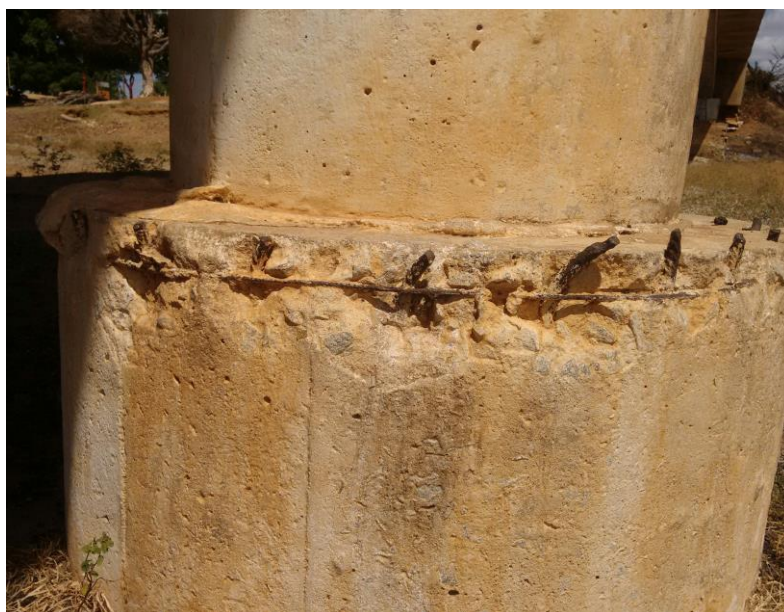
Figura 1 – Armadura exposta e oxidada.
