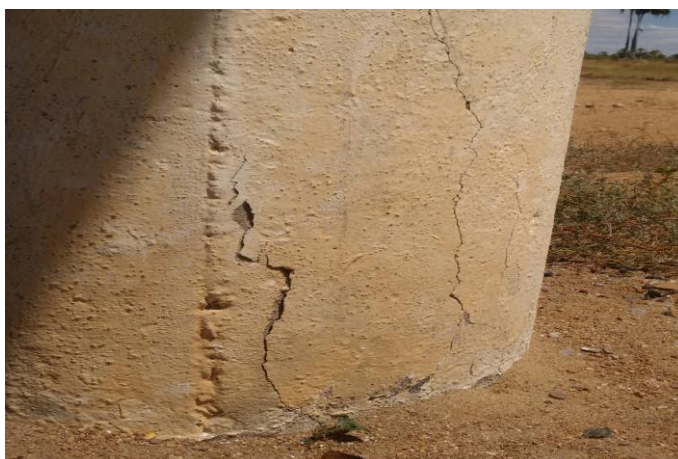
Figura 12 – Fissura no pilar P4.
