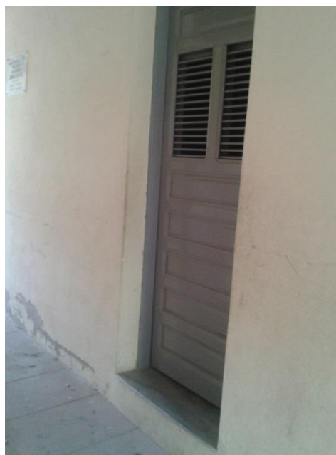
Figura 21: Sala do bloco posterior com desnível sem tratamento de rampa.
