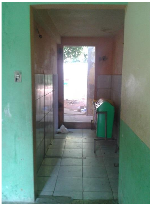
Figura 20: Circulação com desnível em desacordo com a norma.
