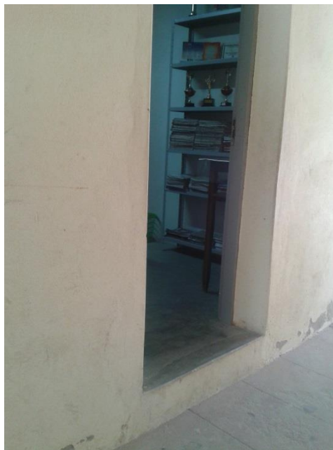
Figura 22: Desnível no acesso à biblioteca.
