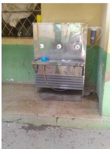
Figura 19: Desnível no entorno do bebedouro.
