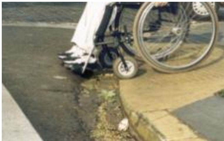
Figura 2: Detalhe de irregularidade na pavimentação.
