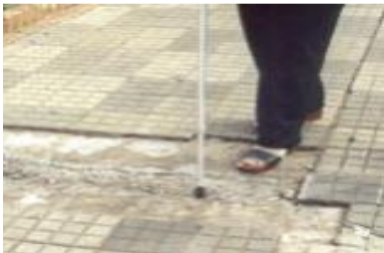
Figura 4: Falta de manutenção no piso dificulta a passagem de pessoas com dificuldades de locomoção.
