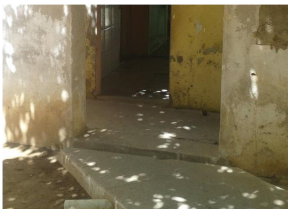
Figura 23: Vão de 12 cm dificulta o acesso ao bloco posterior.
