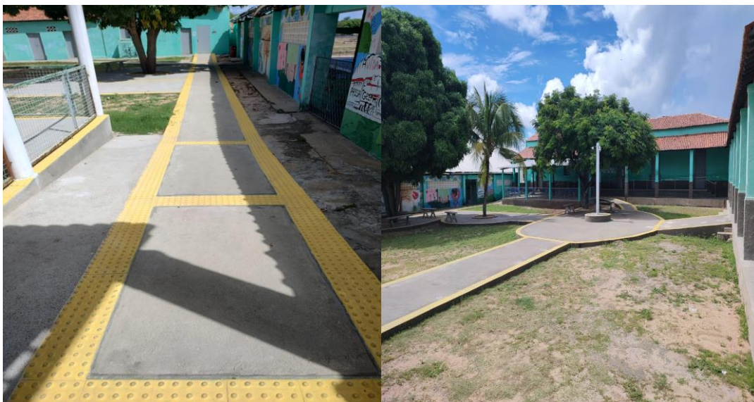
Figura 26 - Desníveis na praça localizada no Bloco A
