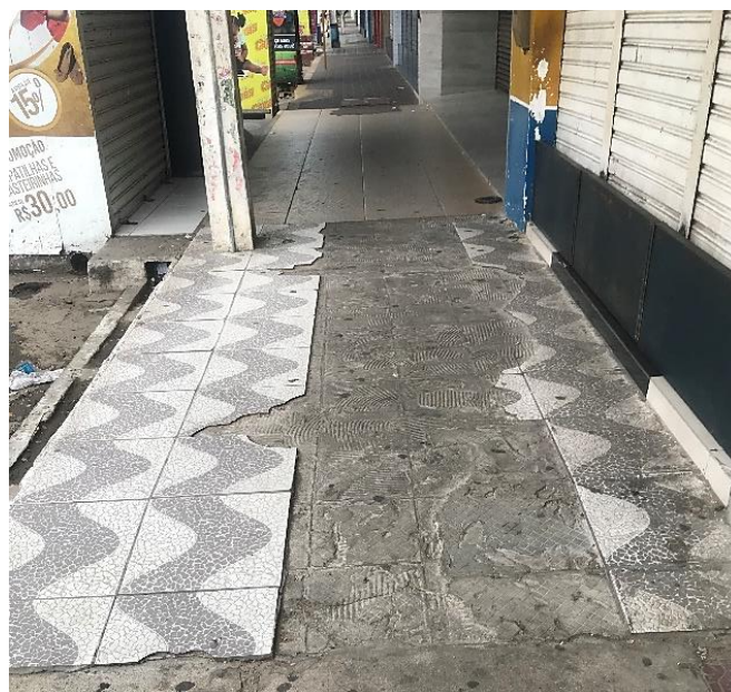
Figura 4. Destacamento de revestimento evidenciando falta de manutenção na pavimentação da área de estudo. (Autoria Própria)
