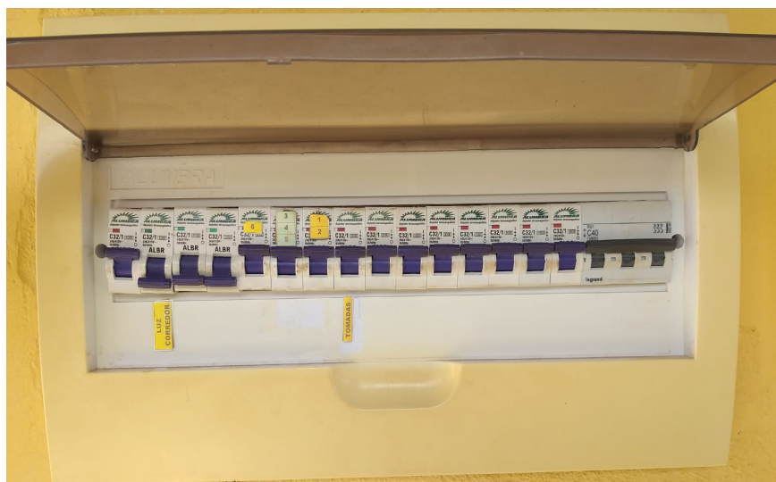
Figura 23 - Quadro de distribuição da iluminação e ar condicionados.
