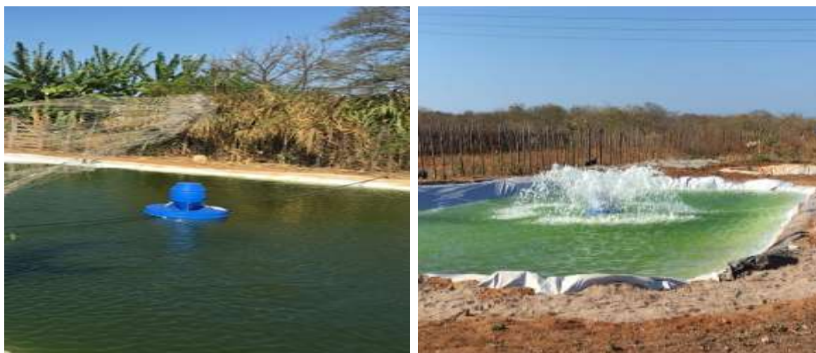
Figura 5. Aeradores instalados nos viveiros de piscicultura para oxigenação da água. Fonte: Dados do acervo da pesquisa.
