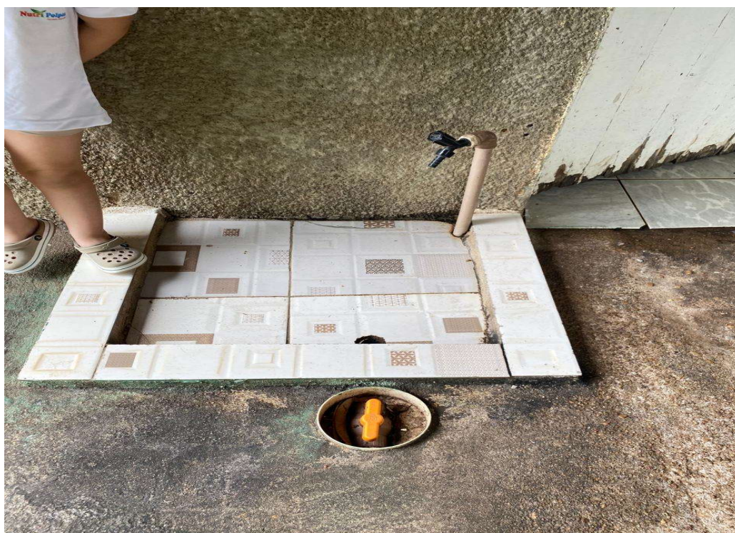
Figura 11 – Área de higienização dos pés, antes e após a saída de funcionários na fábrica Nutripolpas em Quixeré – CE, seguindo a Lei nº 13.648, de 11 de abril de 2018.
