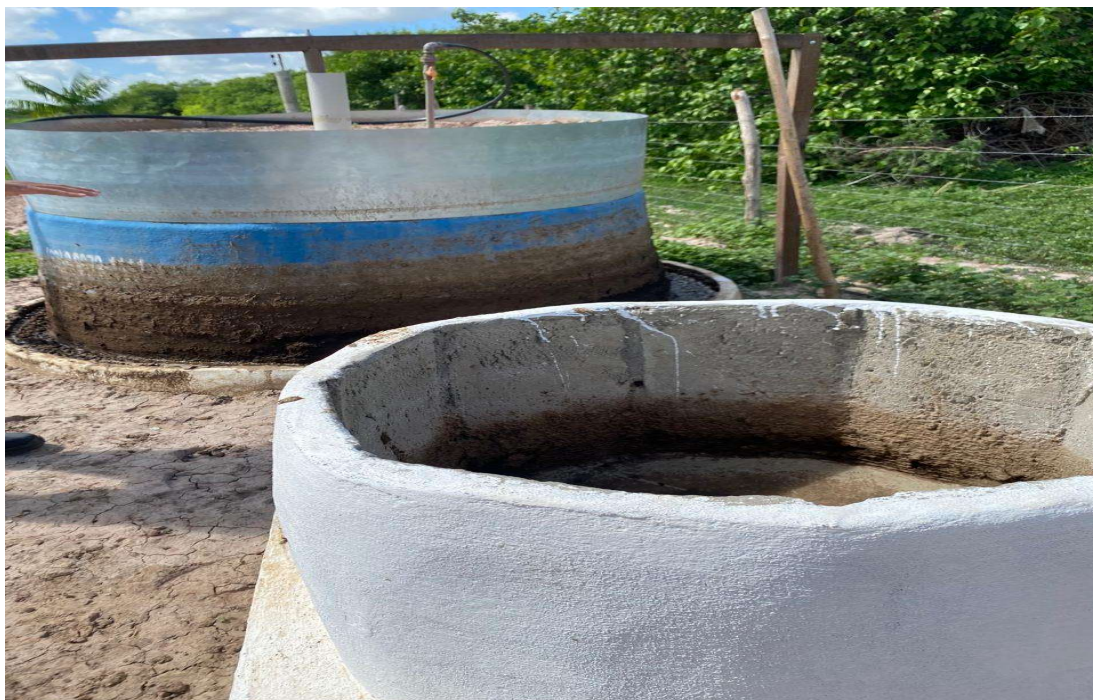
Figura 7 – Localização dos tanques do biodigestor do Projeto Comunidades Vivas na comunidade Poço da Onça em Quixeré – CE, onde é inserido os dejetos dos bovinos para a produção do gás metano.
