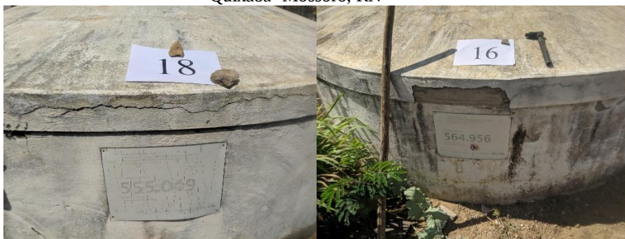
Figura 9: Reservatórios com lateral superior danificada com trincas e rachaduras no Assentamento Quixaba- Mossoró, RN
