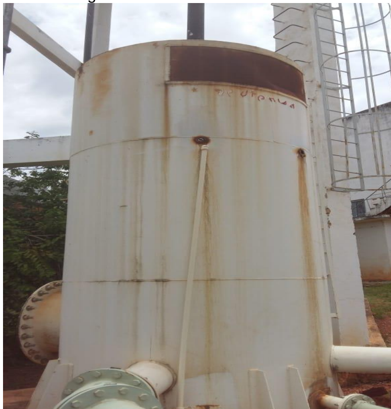
Figura 29: Reservatório cilíndrico B
