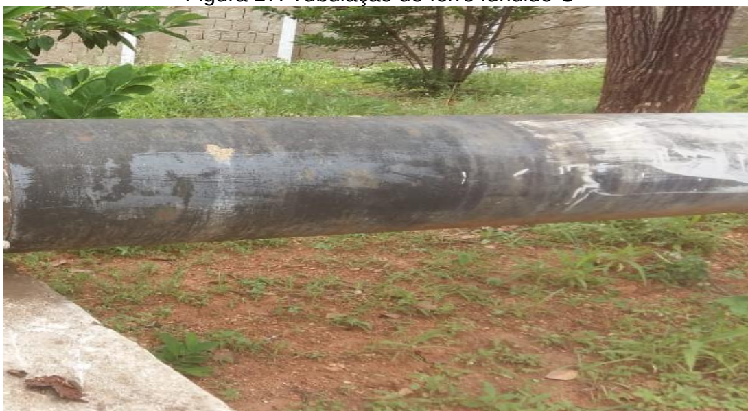
Figura 17: Tubulação de ferro fundido C
