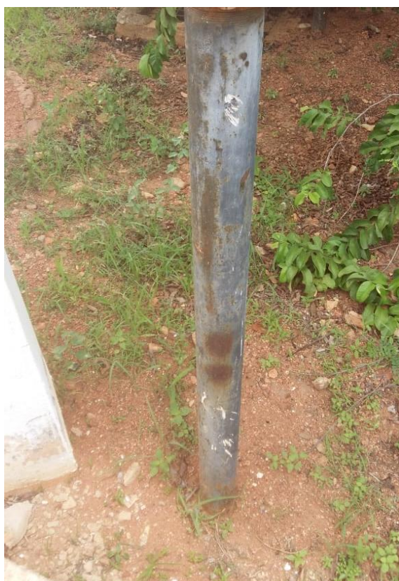
Figura 15: Tubulação de ferro fundido A
