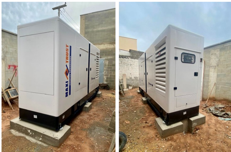
Imagem 3 - Gerador Maxi Trust localizado em uma das unidades da rede de supermercados.
