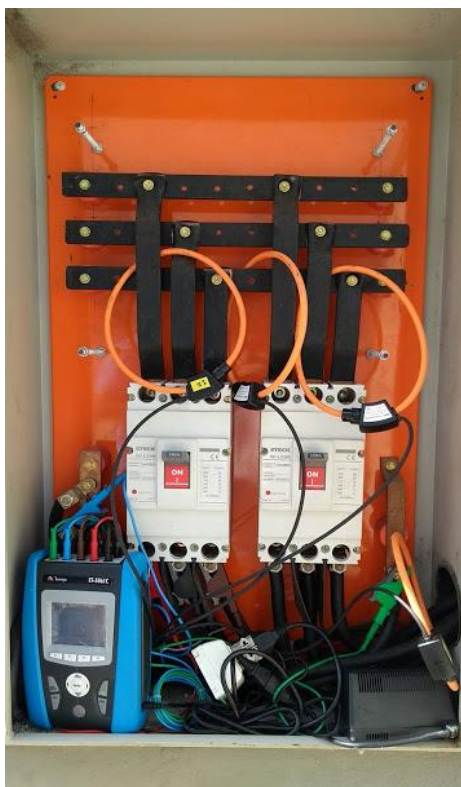
Figura 17 – Analisador de energia instalado no quadro de proteção geral
