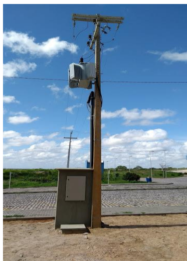
Figura 11 – Quadro de Proteção Geral
