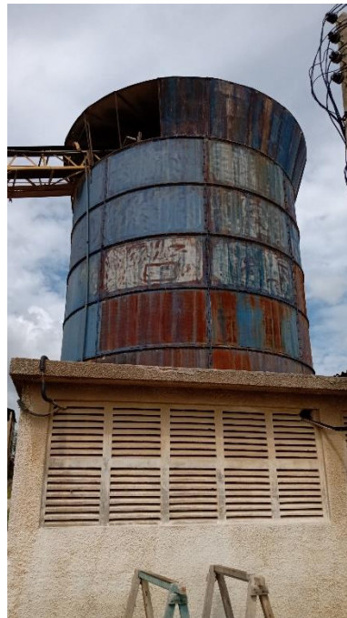
Figura 17 - Silo de Armazenamento
