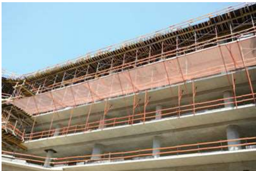
Figura 8 - Rede de Proteção Contra Queda em Obras
