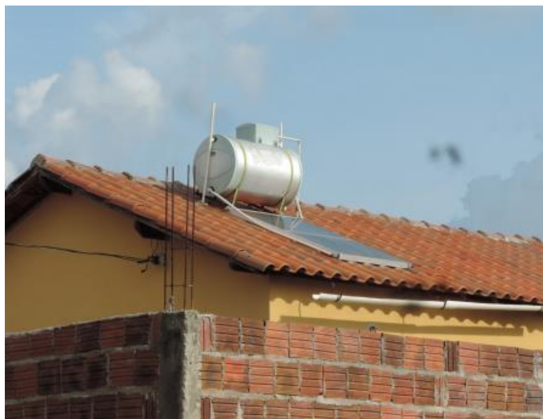
Figura 35 - Telhado da residência com o sistema para aquecimento de água
