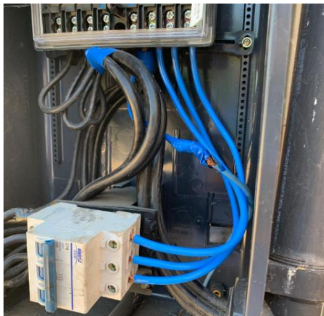
Figura 18 - Cabos de 10mm 2 de cobre flexível entre medição e disjuntor geral.
