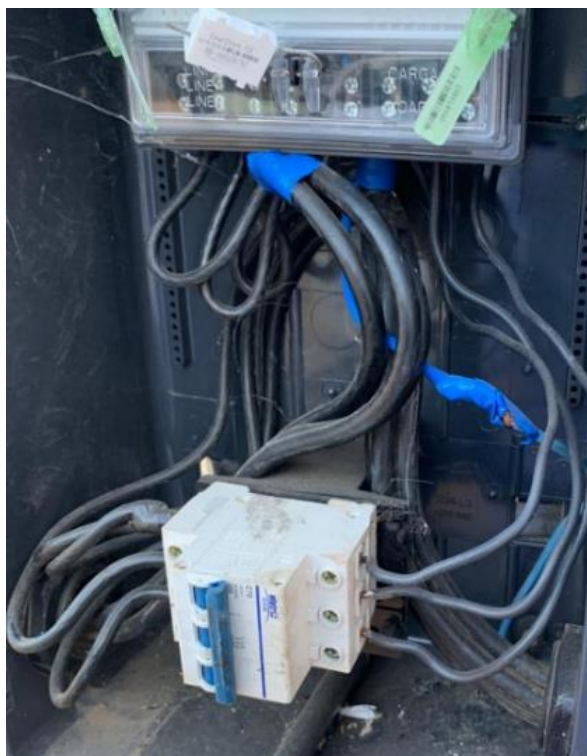
Figura 17 - Cabos de 4mm 2 de cobre rígido entre medição e disjuntor geral.
