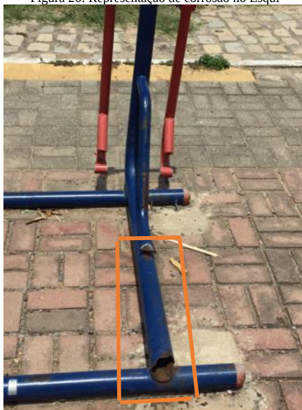
Figura 26: Representação de corrosão no Esqui
