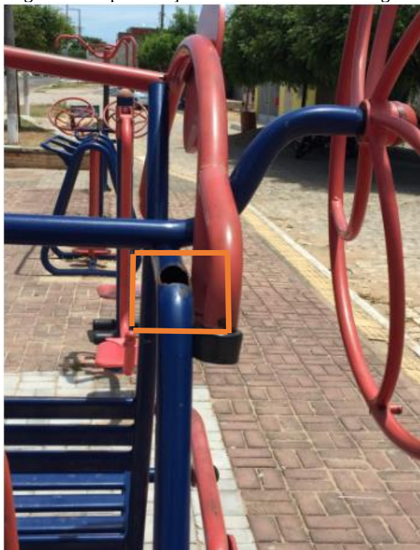
Figura 25: Representação de corrosão no Giro Diagonal
