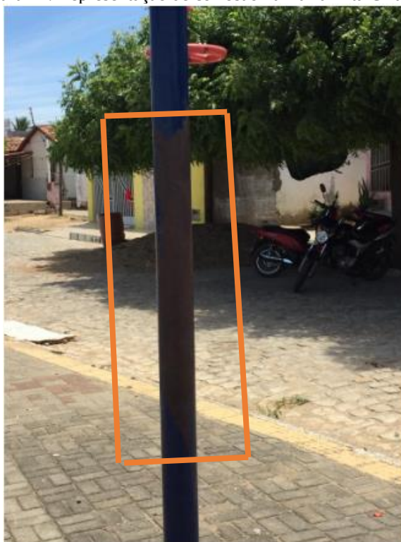
Figura 22: Representação de corrosão na Barra Alta Giratória
