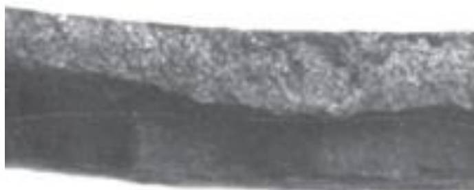
Figura 9: Caracterização de corrosão grafítica
