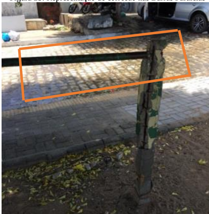
Figura 23: Representação de corrosão nas Barras Paralelas
