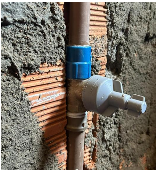
Figura 40 – Registro de pressão do chuveiro, banheiro social
