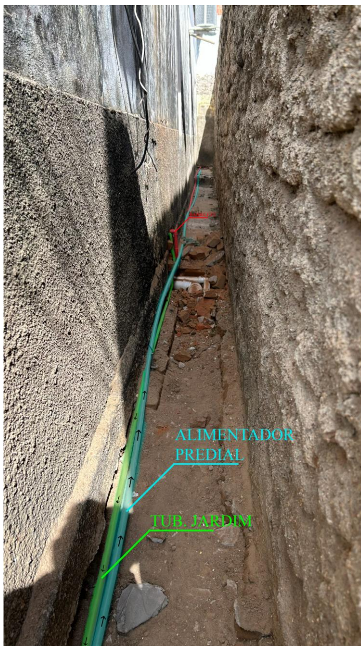
Figura 12 – Tubulação que sai do hidrômetro e segue para o reservatório
