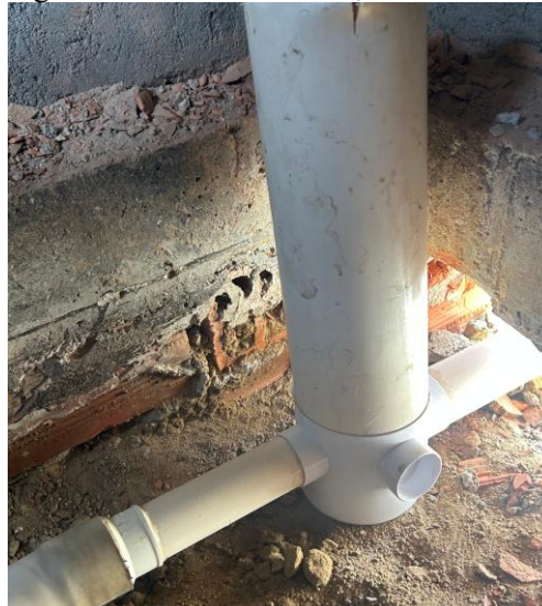
Figura 85 – Caixa sifonada, banheiro suíte
