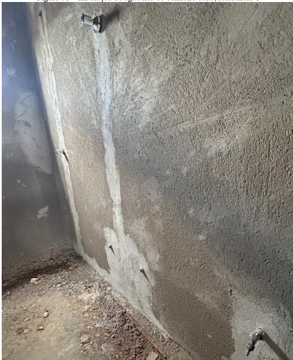
Figura 71 – Instalação de água fria do banheiro suíte, residência C
