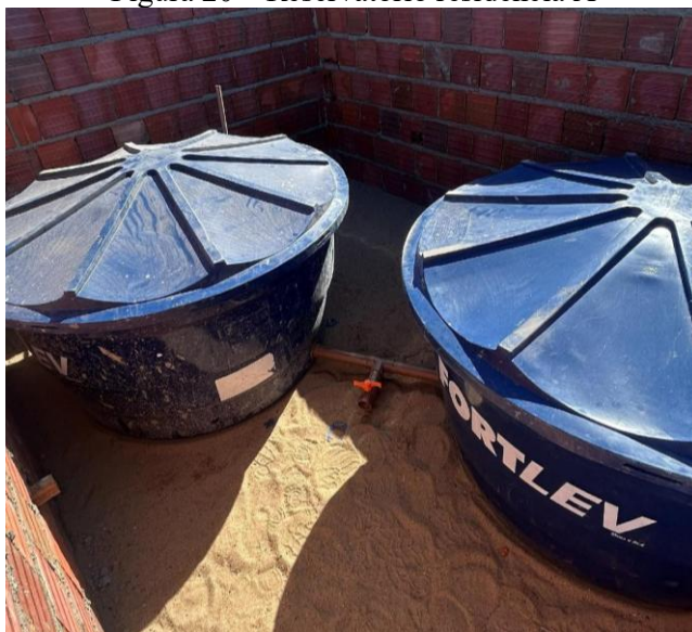
Figura 20 – Reservatório residência A
