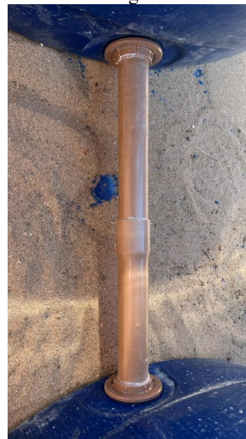
Figura 50 – Ligação entre caixas d'água
