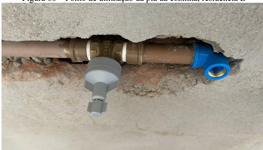
Figura 60 – Ponto de utilização da pia da cozinha, residência B
