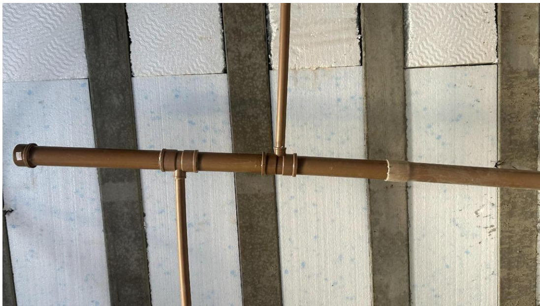
Figura 29 – Terminal do barrilete
