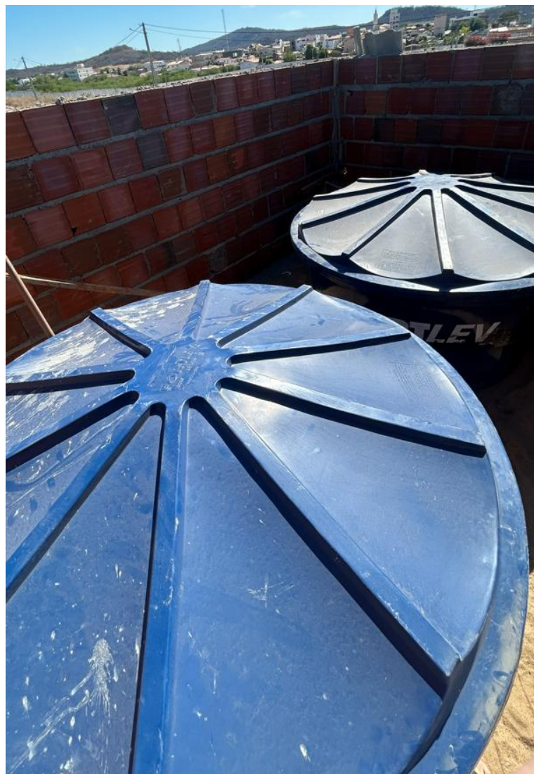
Figura 47 – Reservatório da residência B
