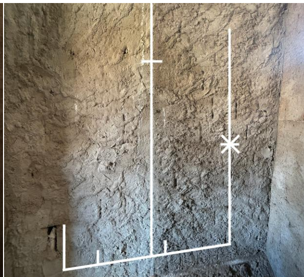
Figura 55 – Traçado realçado sobre a parede, banheiro suíte residência B
