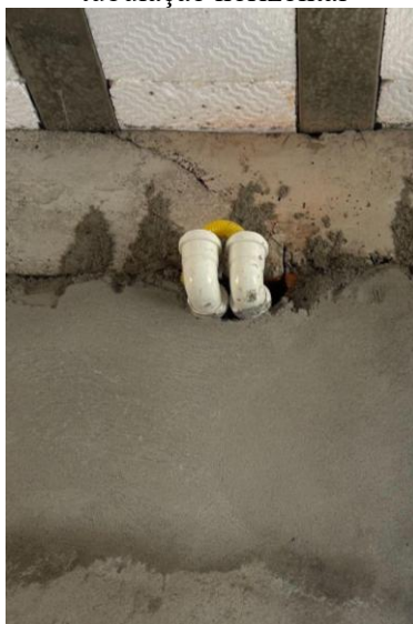
Figura 110 – Passagem para tubulação horizontal
