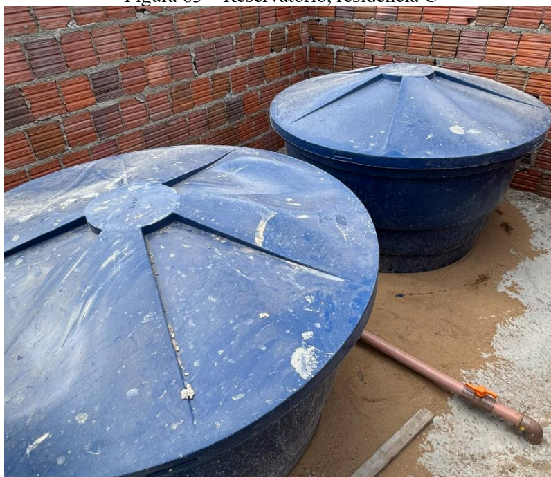
Figura 63 – Reservatório, residência C
