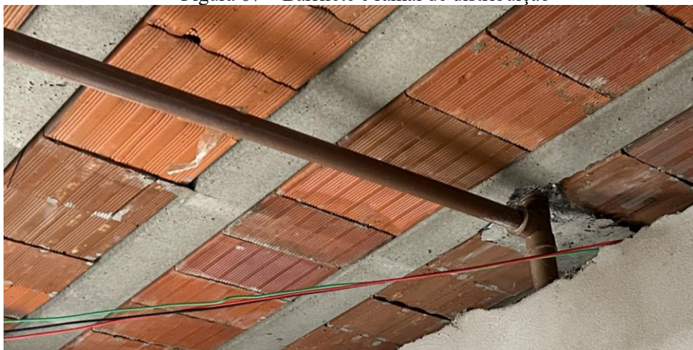
Figura 67 – Barrilete e ramal de distribuição
