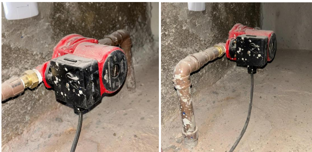
Figura 17 – Bomba Pressurizadora Worker
