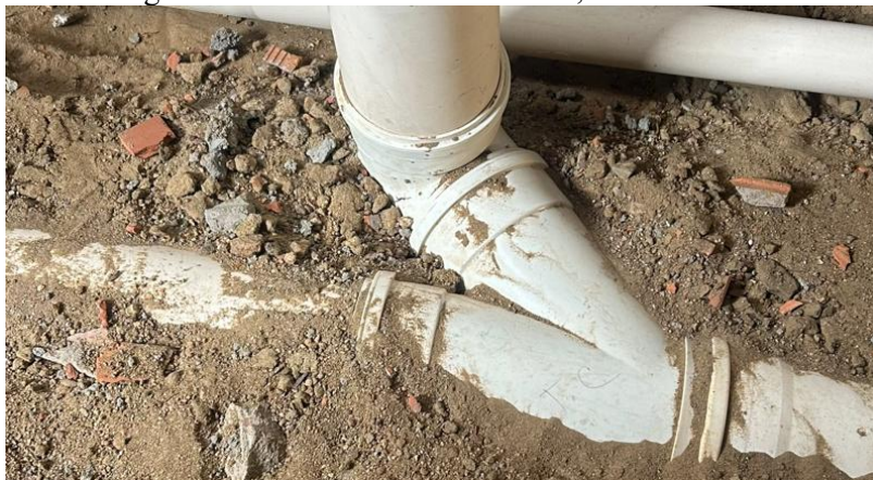
Figura 79 – Ponto da bacia sanitária, banheiro suíte
