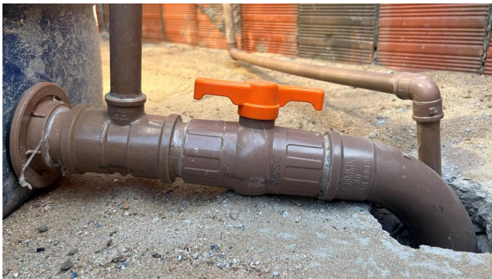
Figura 27 – Tubulação de distribuição, Residência A
