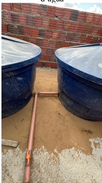
Figura 64 – Ligação entre caixas d'água
