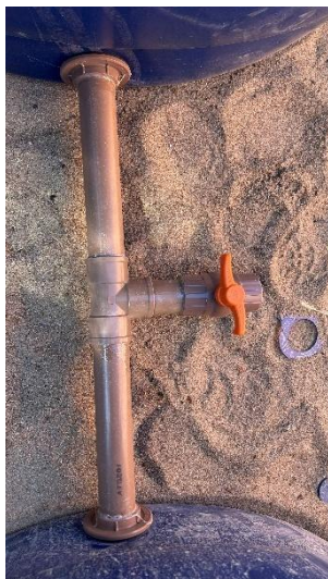
Figura 24 – Ligação das caixas d'água
