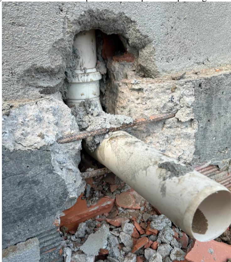
Figura 99 – subcoletor da pia da cozinha passando pela viga baldrame
