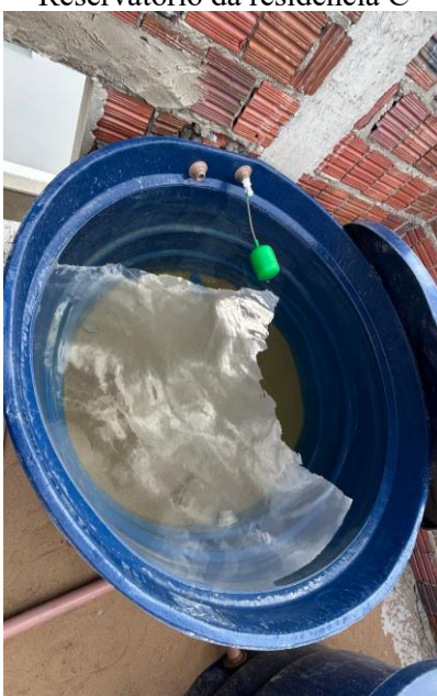
Figura 65 – Alimentação do Reservatório da residência C
