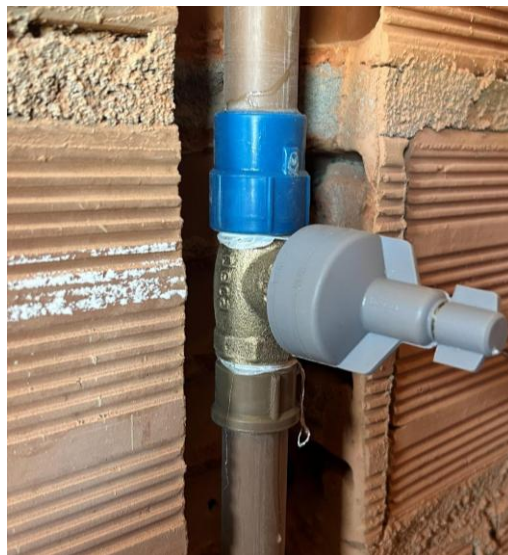
Figura 41 – Registro de pressão do chuveiro, banheiro suíte
