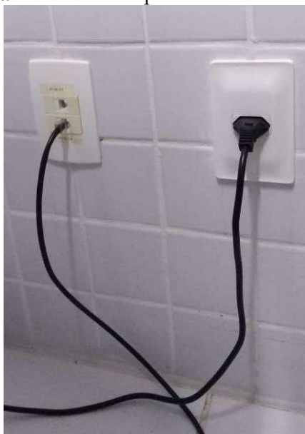
Figura 17- Detalhe de pontos elétrico da sala 16
