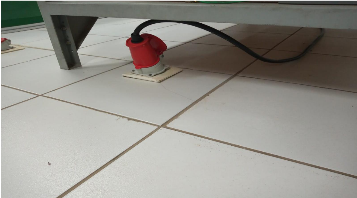
Figura 04: Tomada Industrial no Chão no Laboratório de Instalações e Máquinas
