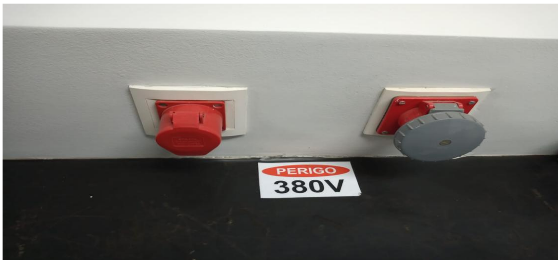
Figura 07: Tomadas na Bancada no Laboratório de Instalações e Máquinas
