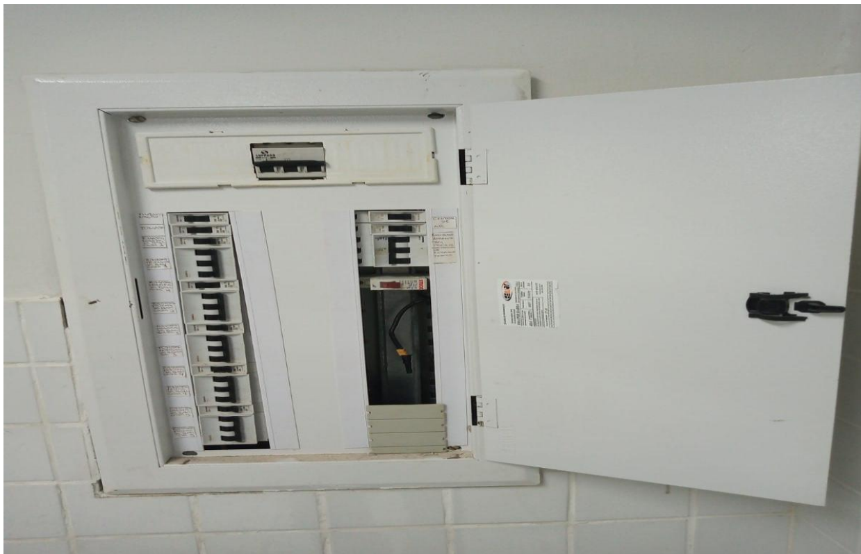
Figura 03: Quadro de Distribuição do Laboratório de Instalações e Máquinas
