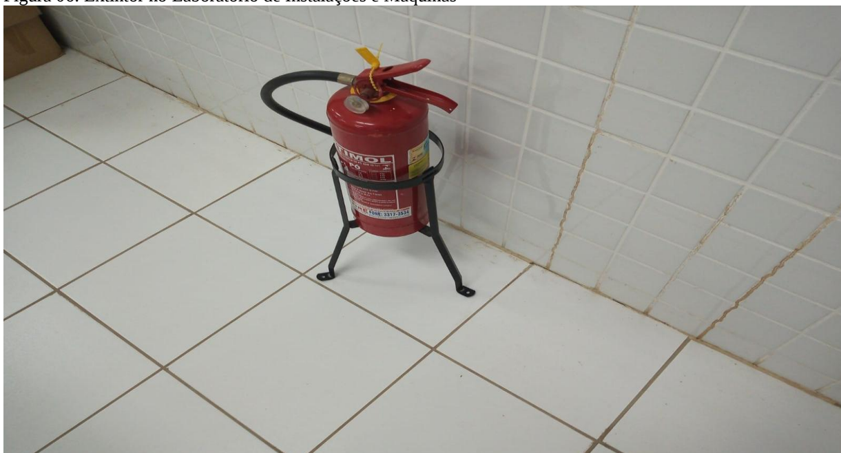
Figura 06: Extintor no Laboratório de Instalações e Máquinas
