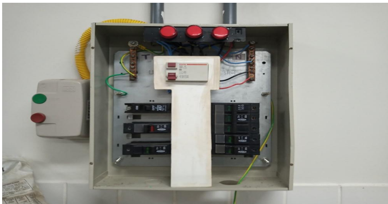
Figura 10: Painel elétrico para aulas práticas
