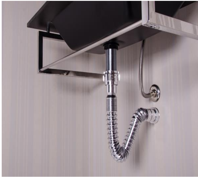
Figura 21: Sifão instalado corretamente
