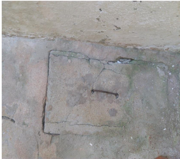
Figura 23: Tapa danificada da caixa de gordura
