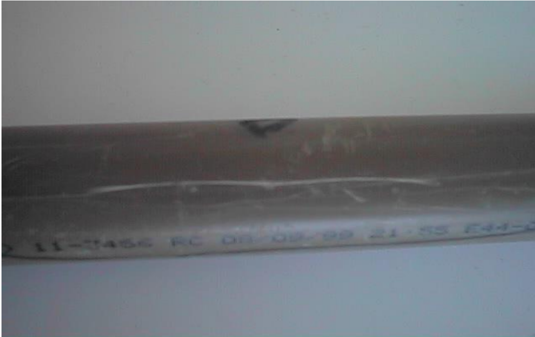
Figura 13: Fissura na tubulação
