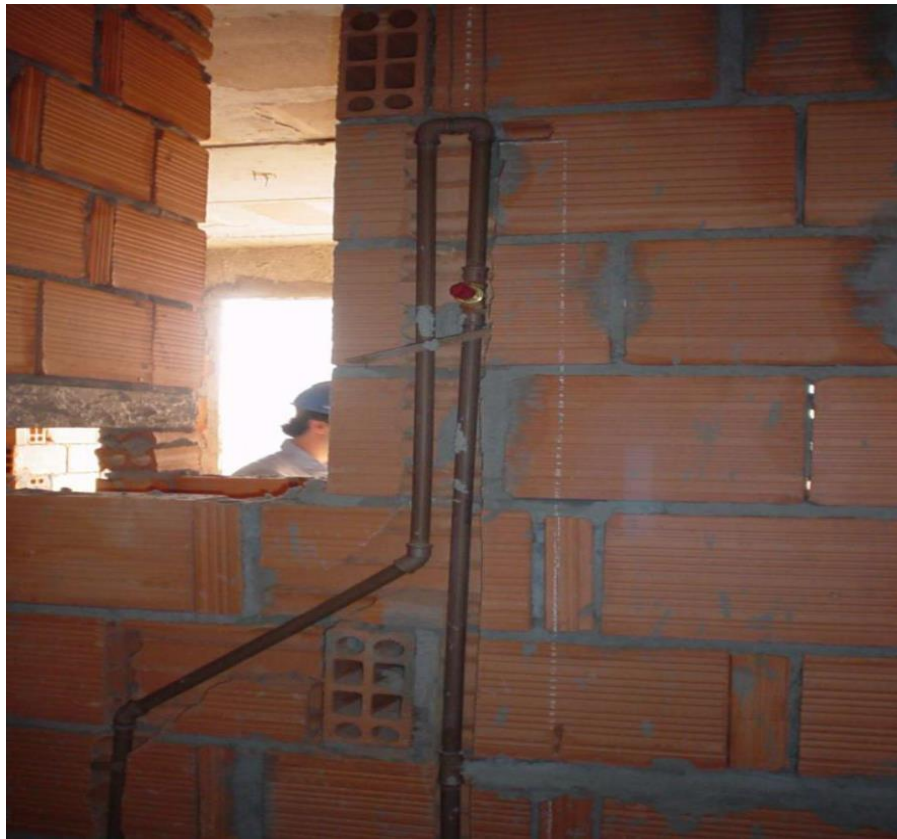
Figura 16: Tubulação em U invertido
