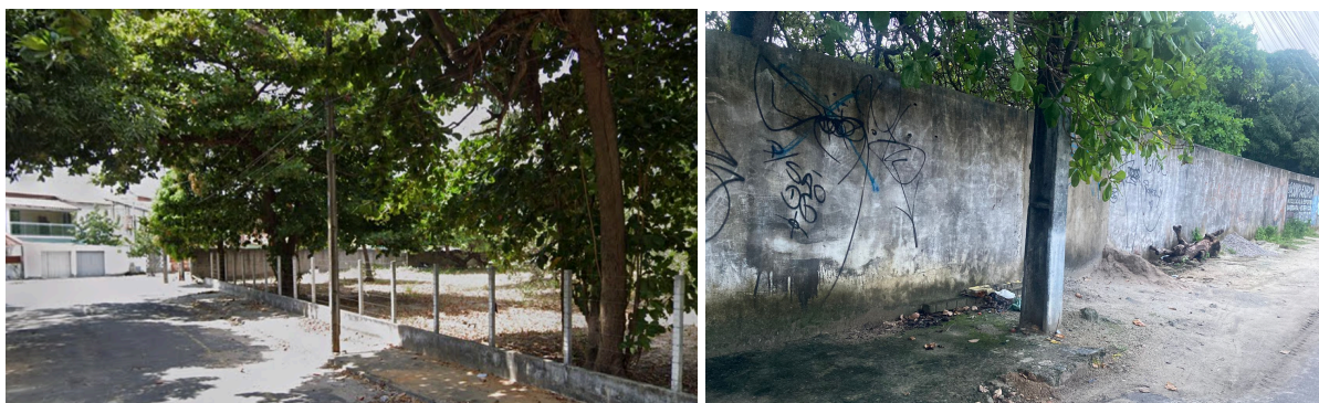
Figura 15 – Postes de energia posicionados no centro da faixa livre
