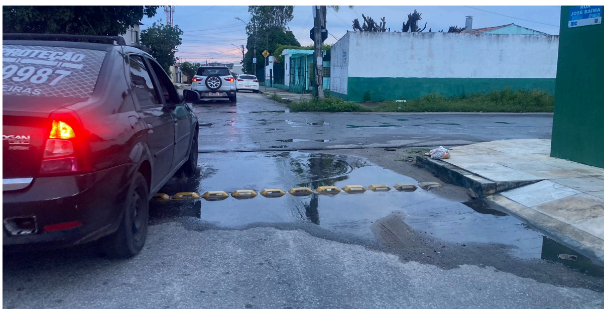
Figura 14 – Ausência de guias rebaixadas (rampas) em esquinas.
