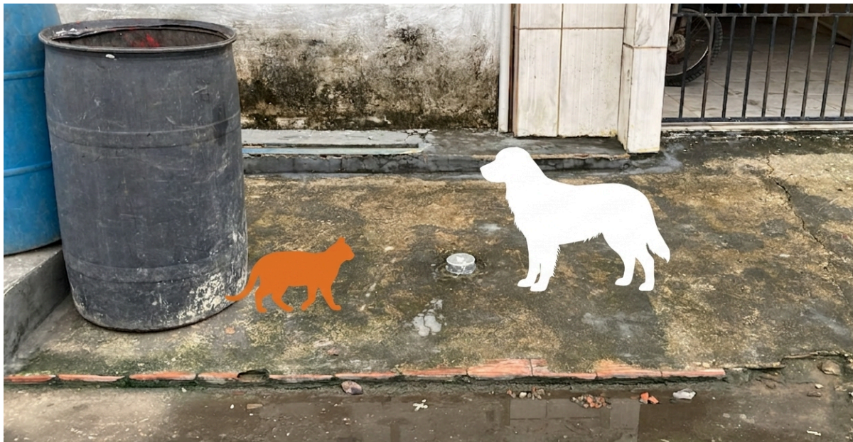
Figura 10 – Dispositivos de inspeção (fossas) com desnível na calçada
