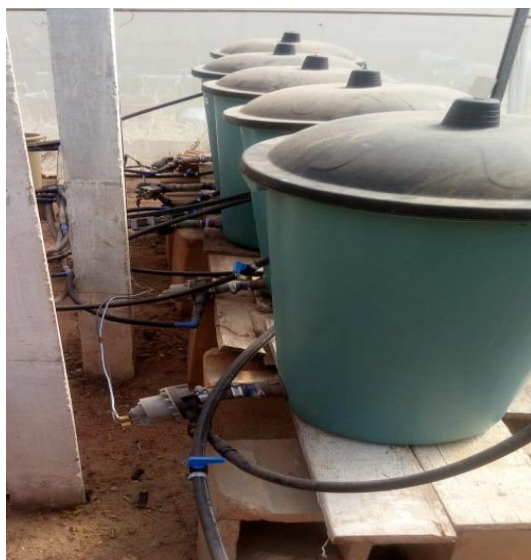
Figura 8a: Reservatórios de irrigação e Eletrobombas.
