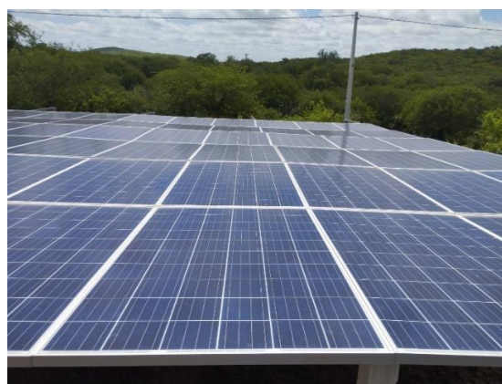
FIGURA 10. Deformação de módulos fotovoltaicos.
