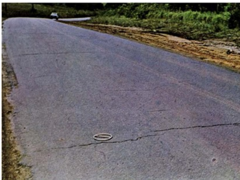
Figura 2 – Trincas isoladas: Transversal
