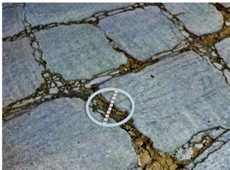
Figura 5 – Trincas interligadas: Tipo bloco
