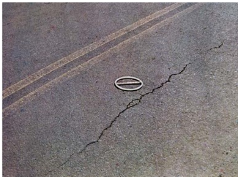
Figura 3 – Trincas isoladas: Longitudinal
