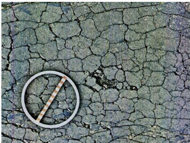
Figura 4 – Trincas interligadas: Tipo jacaré
