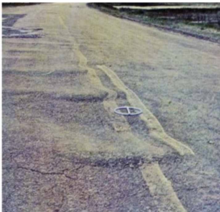
Figura 8 – Ondulação ou corrugação
