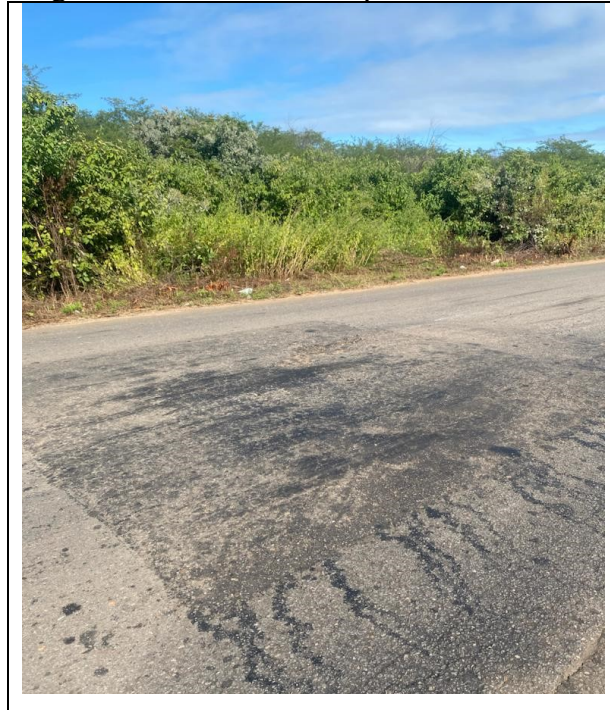
Figura 17 – Defeitos de superfície: remendos
