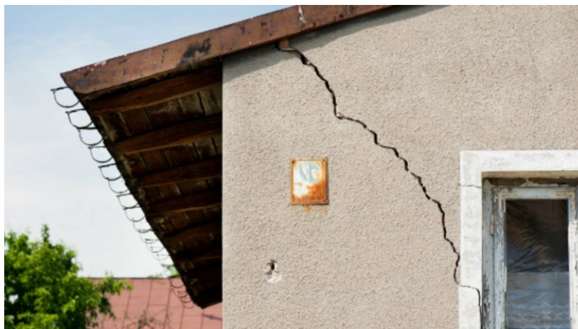
Figura 2 – Fissura em imóvel residencial.
