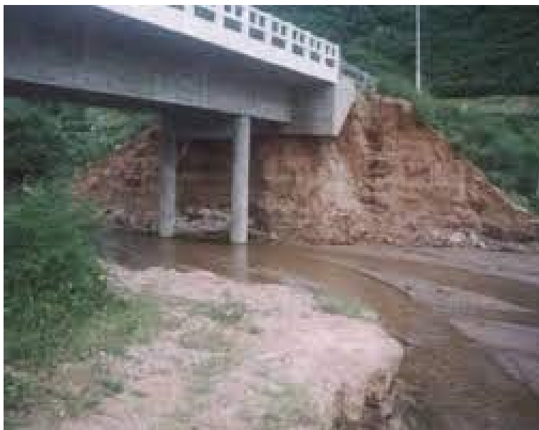
Figura 3 – Erosão causada pela locação da ponte em trecho curvo do rio.
