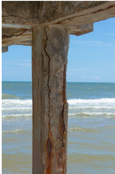
Figura 4 – Processo de corrosão em estrutura de concreto armado.
