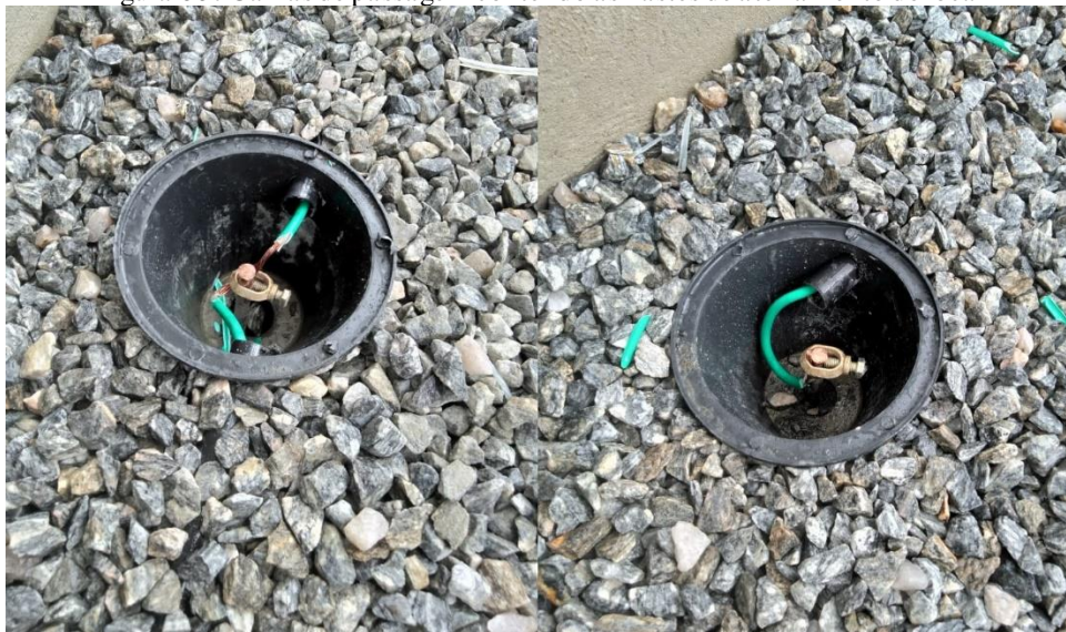
Figura 33: Caixas de passagem contendo as hastes de aterramento do local
