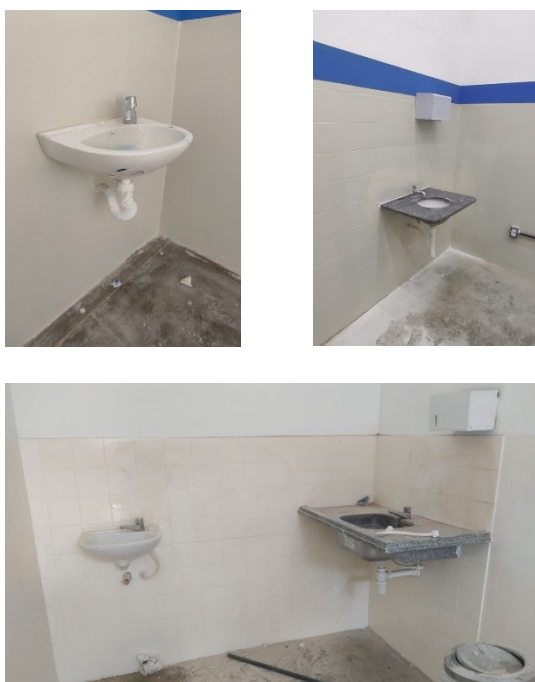
Figura 15 – Pias, bancadas e torneiras das salas do centro clínico
