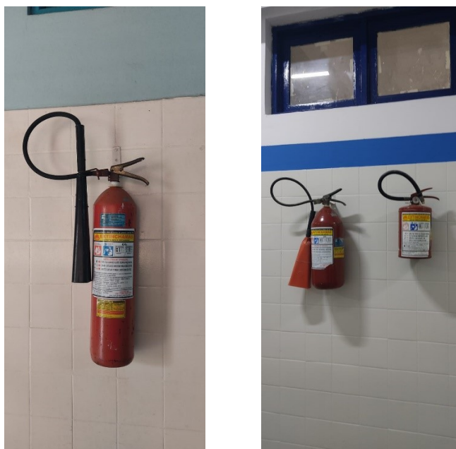
Figura 20 – Extintores da edificação
