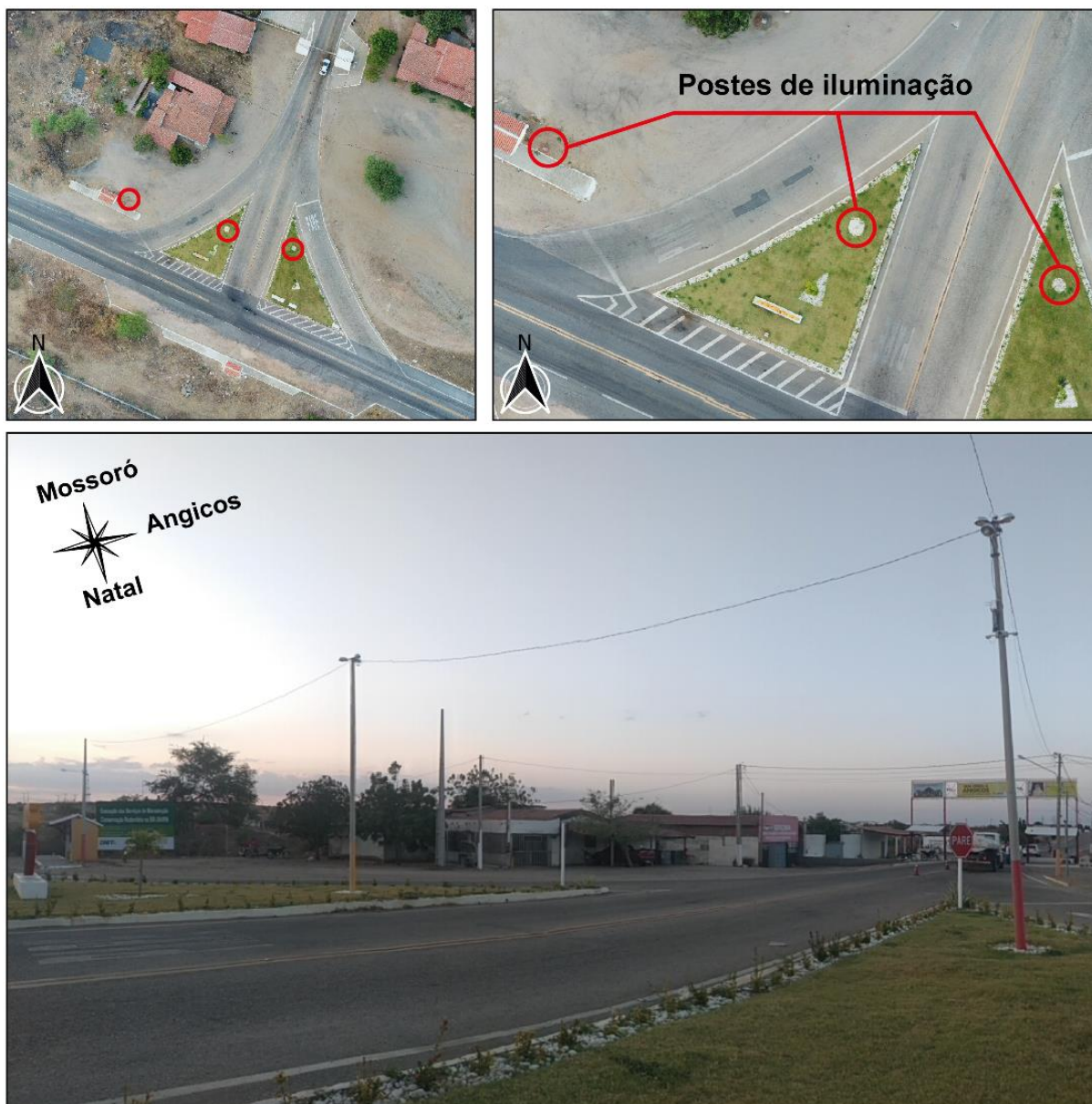
Figura 70 – Postes de iluminação pública
