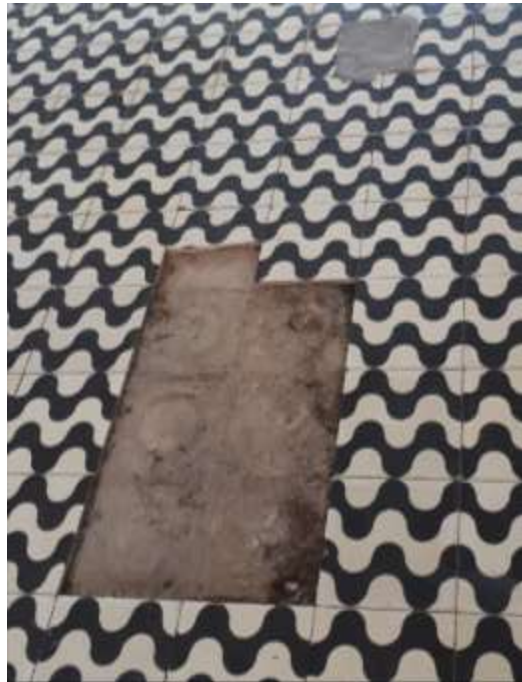
Figura 14 – Deslocamento de piso cerâmico no prédio central na área de circulação, lado Oeste.
