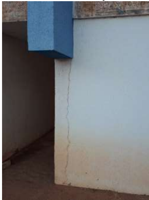
Figura 08 – Alvenaria externa com fissura vertical no prédio central, lado Oeste.
