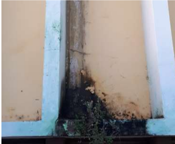
Figura 16 – Infiltração, bolor e cobertura vegetal em alvenaria externa do prédio do DCV – Fitossanidade.
