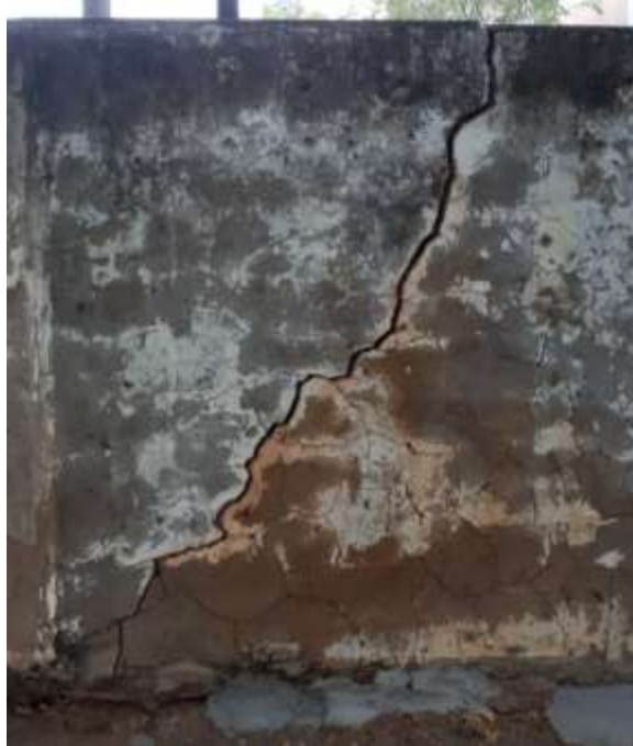
Figura 07 – Rachadura em calçada de concreto em frente ao prédio do DCV.
