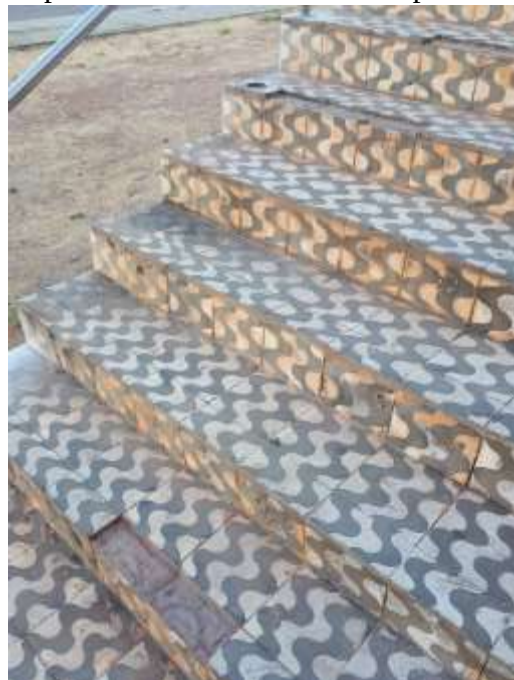
Figura 15 – Deslocamento de piso cerâmico em escada do prédio central, lado Oeste.
