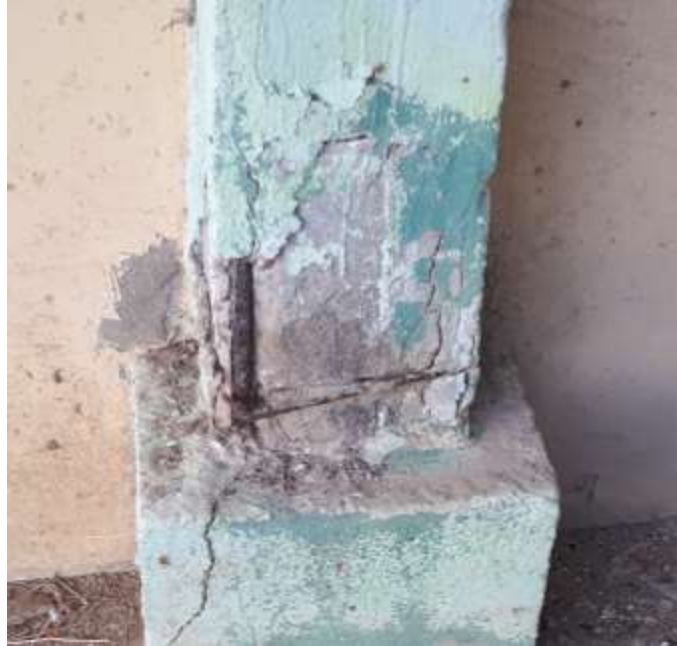
Figura 12 – Corrosão de armadura e desagregação do concreto em pilar da edificação do CA de Agronomia e Veterinária.
