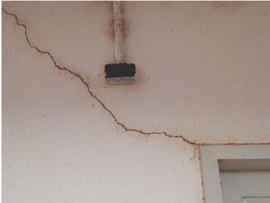
Figura 09 – Trinca inclinada em esquadria do prédio central, lado Oeste.
