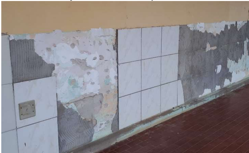
Figura 13 – Deslocamento de placa cerâmica na edificação do DCAT – Anexo I.
