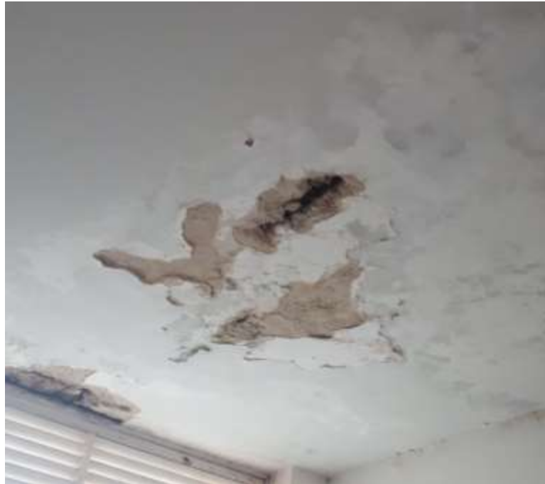
Figura 10 – Corrosão e bolor em laje no banheiro masculino do prédio central, lado Oeste.
