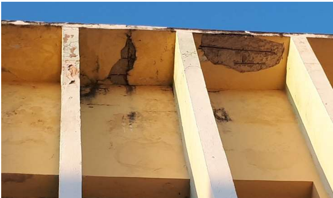
Figura 11 – Corrosão em armadura e desagregação do concreto em laje do prédio DCV - Fitossanidade.
