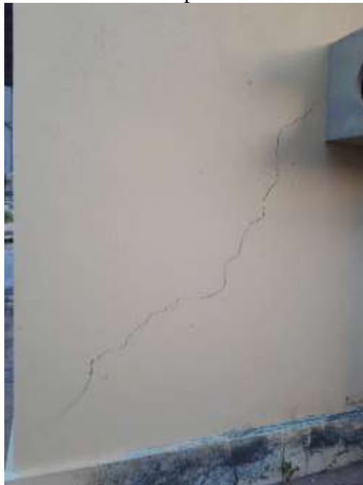
Figura 06 – Alvenaria com trinca inclinada no prédio do DCAT Anexo II.
