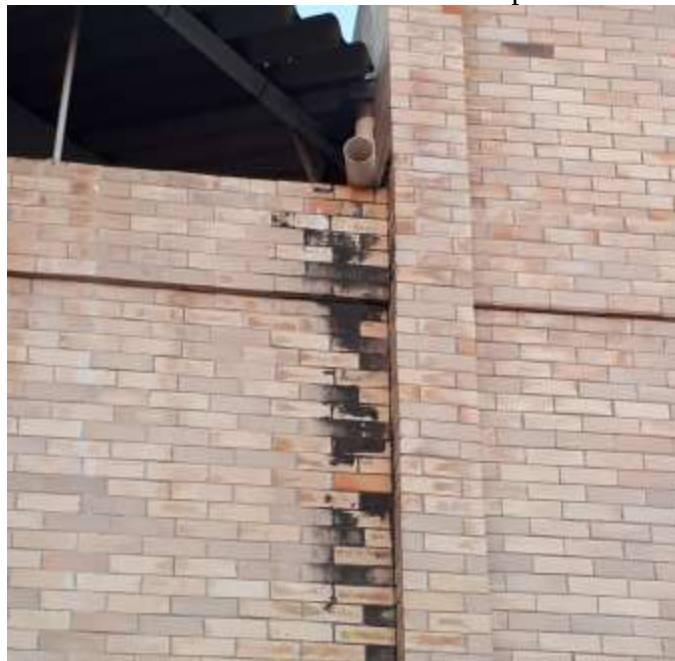
Figura 17 – Bolor e manchas em revestimento externo da capela Católica.
