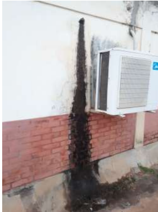
Figura 18 – Bolor em estado acentuado em alvenaria externa do Laboratório de Histologia.
