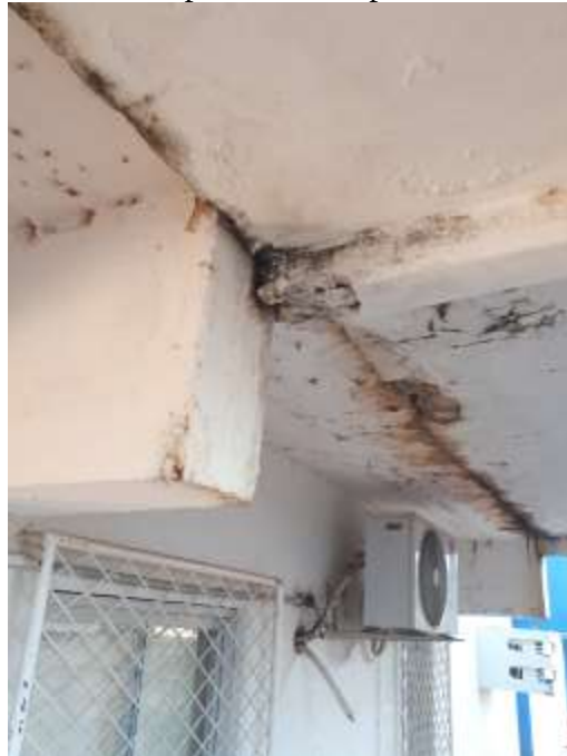
Figura 19 – Manchas e bolor abaixo da passarela do prédio central, lado Oeste.
