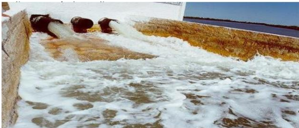
Figura 1 - Captação da água do mar
