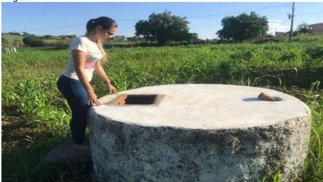
Figura 6: Poço de captação de água subterrânea sem vedação – Comunidade Angicos
