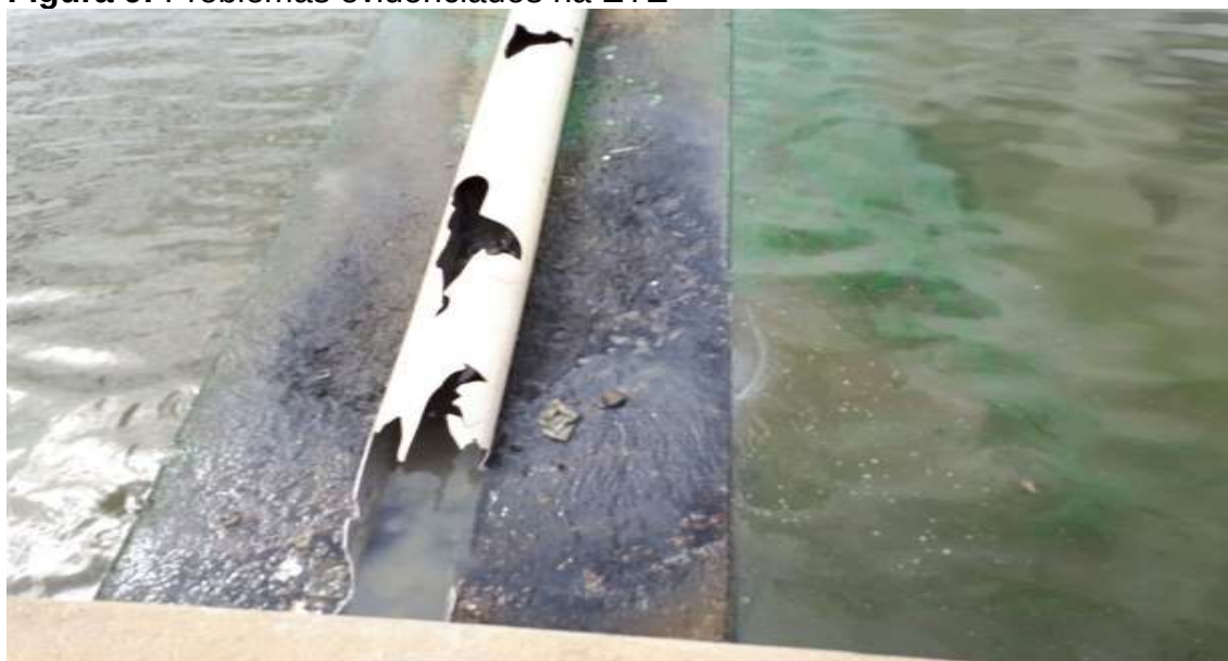
Figura 9: Problemas evidenciados na ETE
