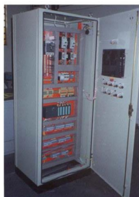
FIGURA 2. Painel UTR instalado. [14]
