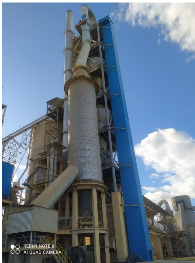
Figura 8 - Torre de arrefecimento da Mizu
