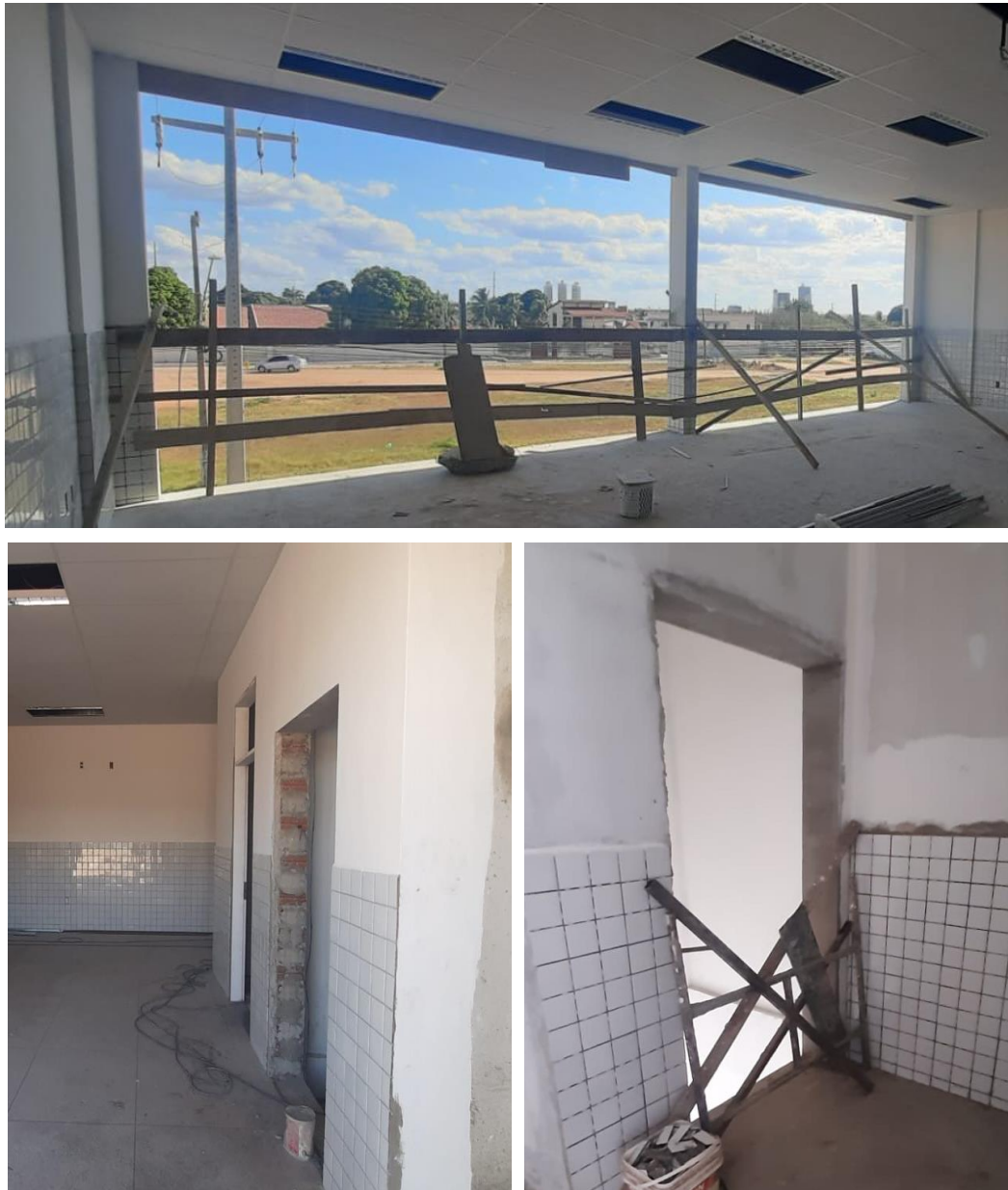
Figura 14 - Medidas contra queda de altura instalado na empresa A Fonte: Autoria própria (2023).
