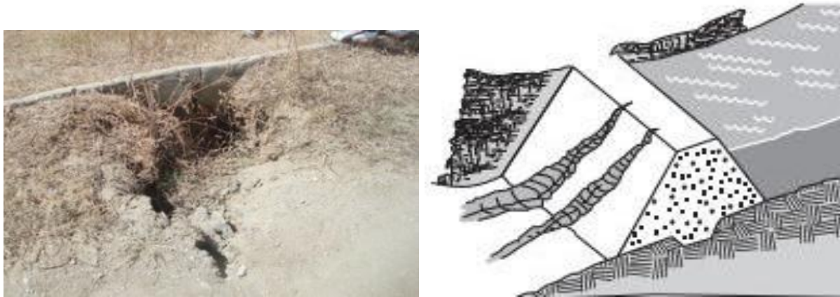
Figura 18: Erosão do talude de jusante na Barragem de Baião-PB
