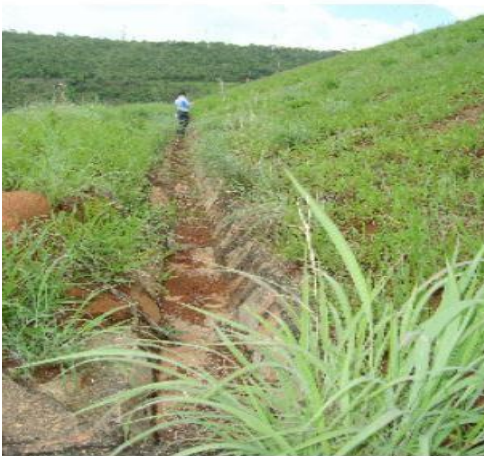
Figura 23: Caneletas de drenagem necessitando de limpeza
