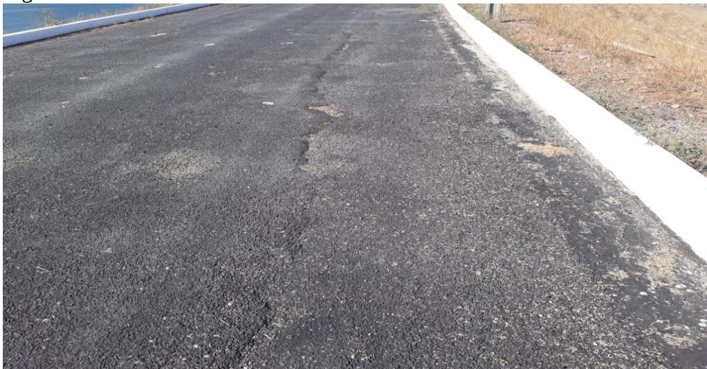
Figura 29: Malha asfáltica com falhas.
