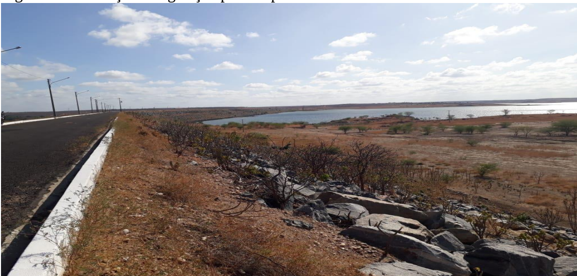
Figura 32: Presença de vegetação parte superior do talude da montante
