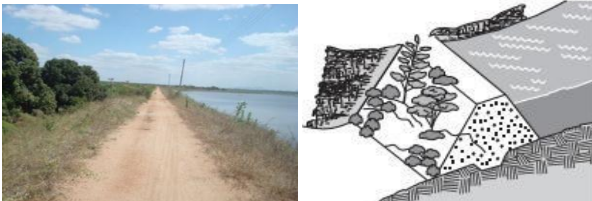
Figura 21: Presença de vegetação a jusante da Barragem de Direito (Paraíba)
