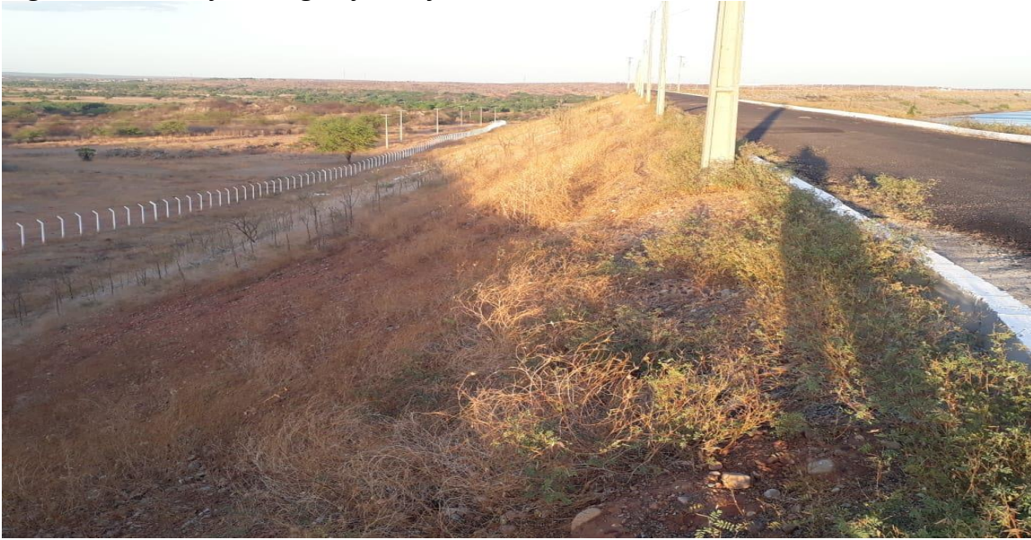
Figura 31: Presença de vegetação na jusante
