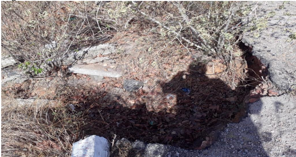
Figura 33: Buraco no talude da montante.
