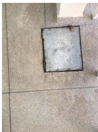
Figura 16 – Cisterna da E. M. Filomena Sampaio de Souza
